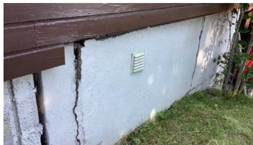
Eksempel på grunnmur som heller utover.
