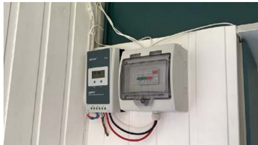
Sikringer på soverom.
