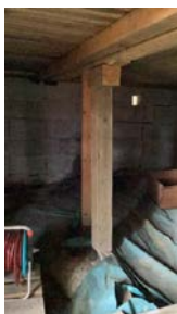
Det er noen understøttelse av tre under bygget
