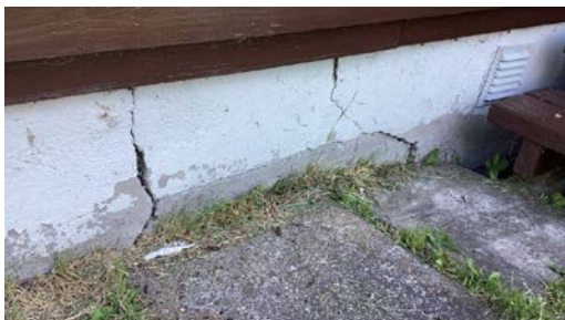
Eksempel på sprekker i grunnmur.
