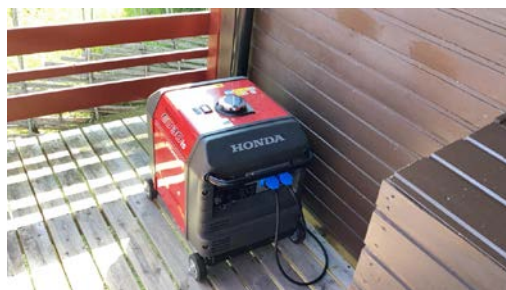
Aggregat har vært plassert på veranda.
