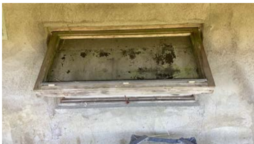
Ett kjellervindu med noe mer slitasje.
