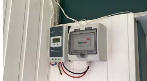
Sikringer på soverom.
