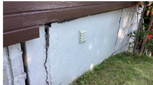
Eksempel på grunnmur som heller utover.
