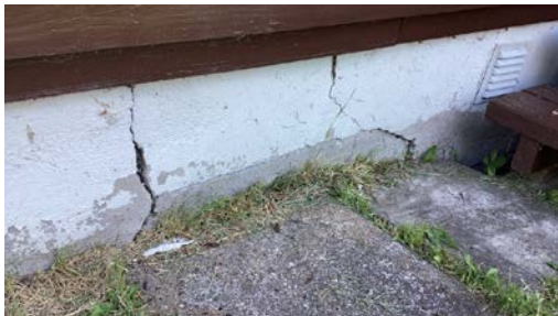
Eksempel på sprekker i grunnmur.
