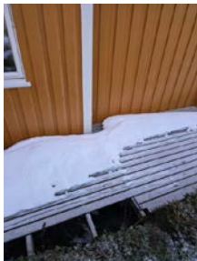
Under terrassen ligger oljetanken
