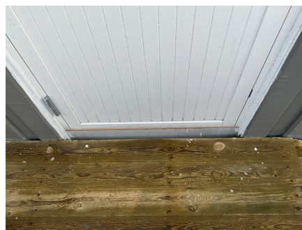
Fuktskader i bunnen av døren.
