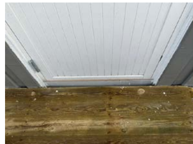
Fuktskader i bunnen av døren.
