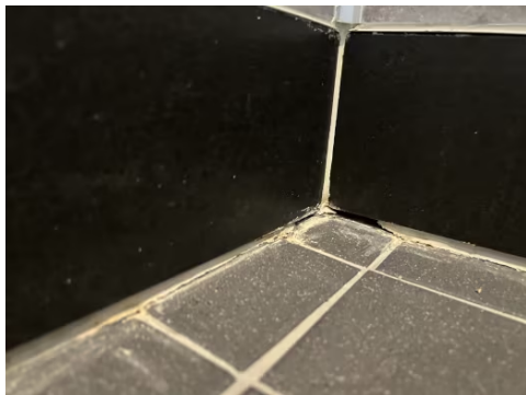
Manglende tetting mellom gulv og sokkelflis.
