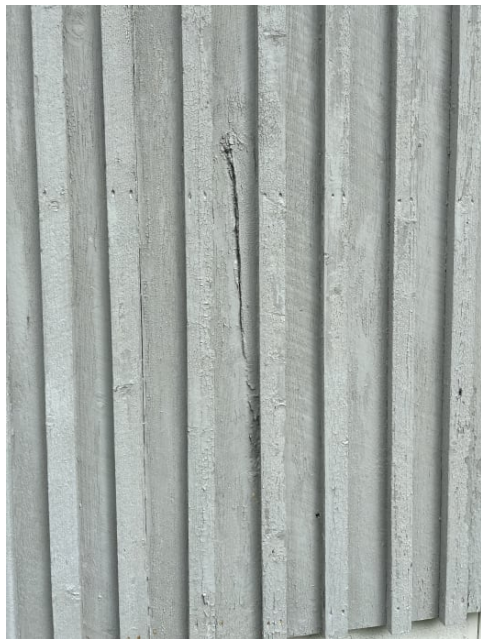
Sprekker i utvendig kledning.
