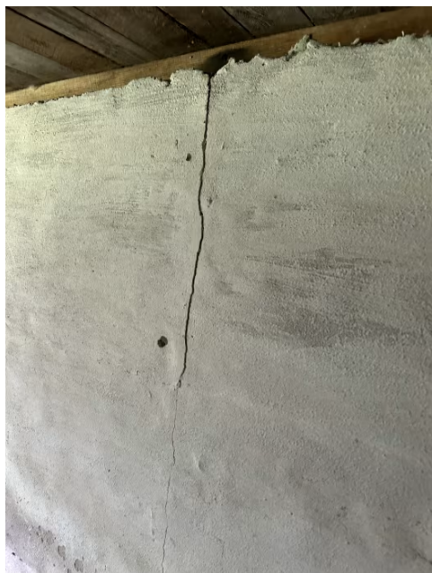
Sprekker i ringmur.
