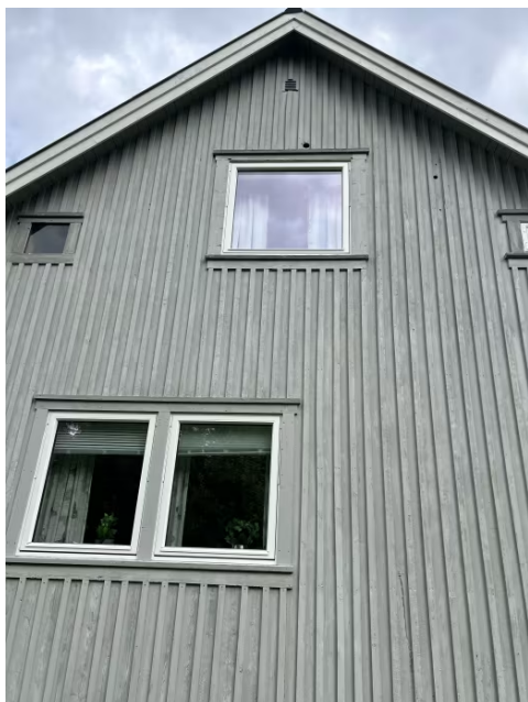
Overflatebehandling bør utføres.
