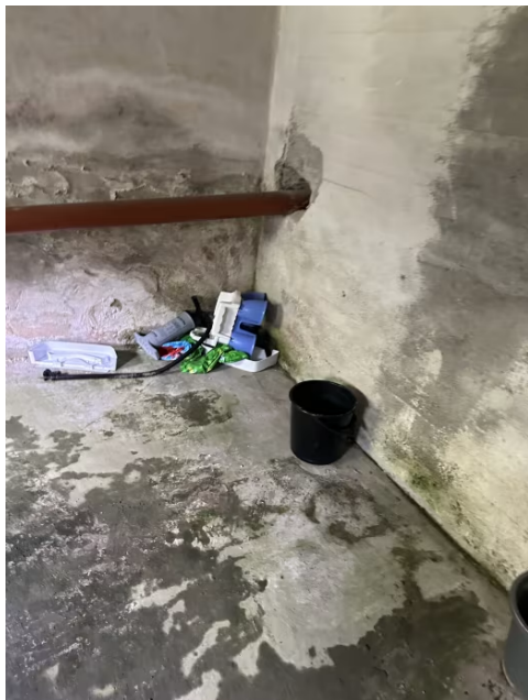
Fukt i kjeller vegg og gulv.
