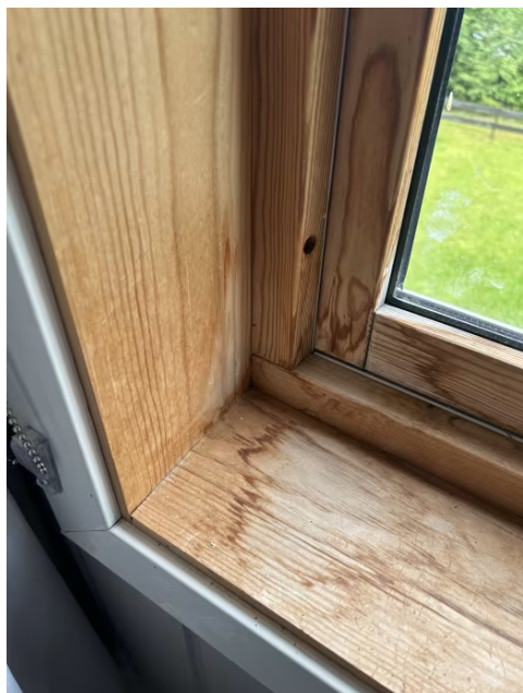
Fuktmerker i vindu.
