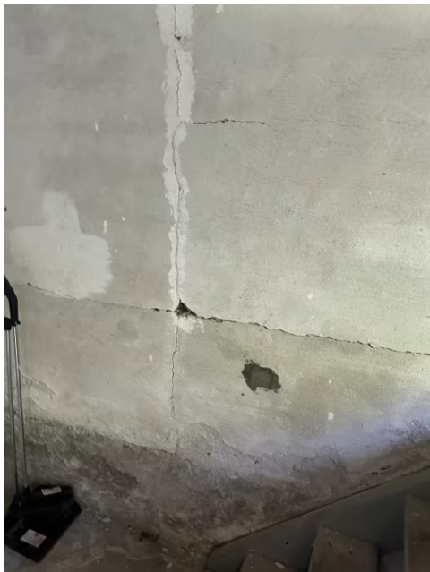
Sprekker i ringmur.
