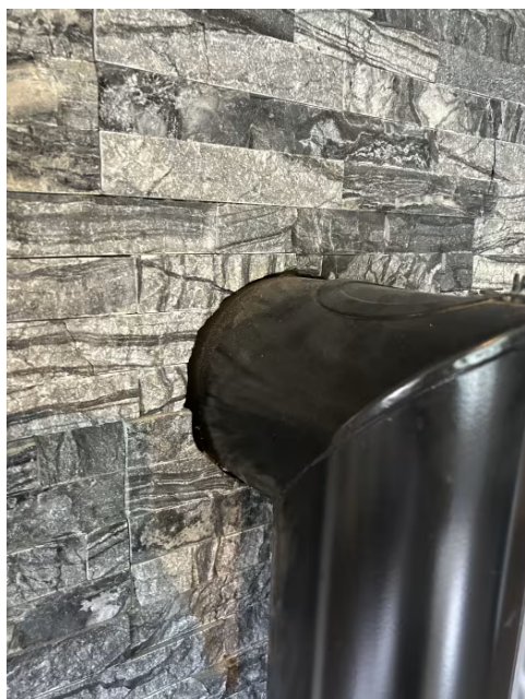
Manglende dekkning rundt røykrør.
