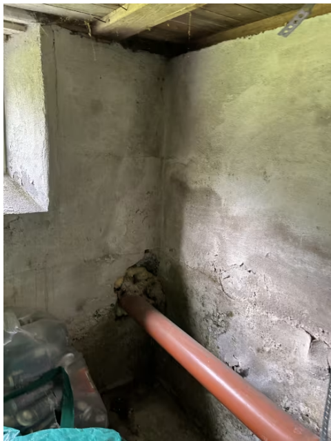
Ikke tettet ordentlig etter oppgradering.
