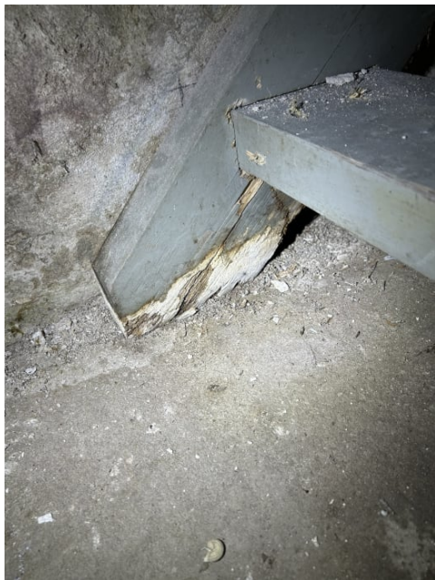
Råte på treverk i kjeller.
