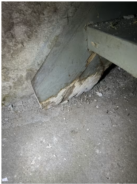
Skader på trapp.
