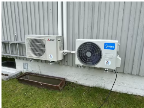
Utvendig del til varmepumpe.
