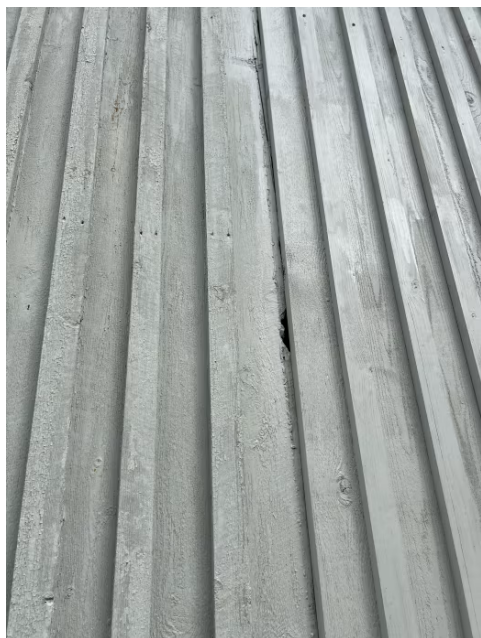
Sprekker i utvendig kledning.
