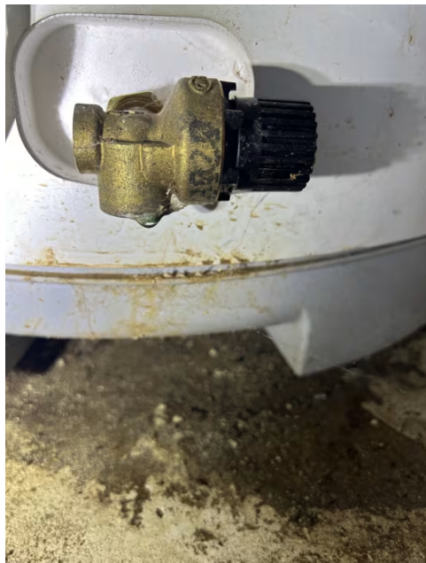
Drypplekkasje fra bereder.
