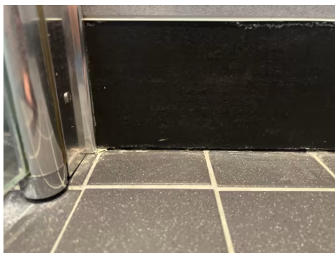
Manglende tetting mellom gulv og sokkelflis.
