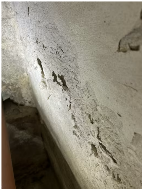
Saltutslag på vegger.
