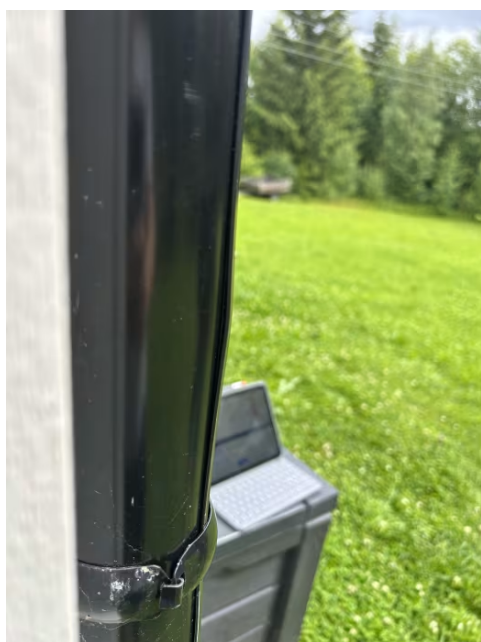
Frostspreng i nedløp.
