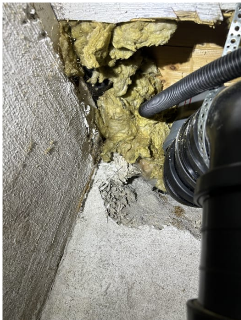
Ikke tettet ordentlig etter oppgradering.
