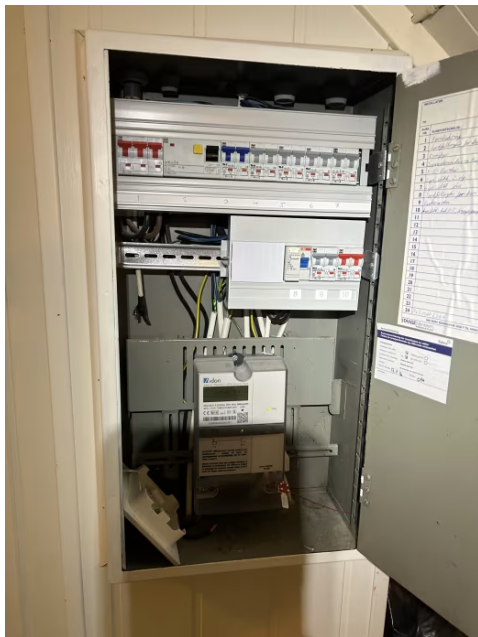
Sikringsskap med løse kabler
