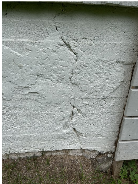
Sprekker i ringmur.
