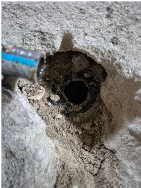
Hull i avløpsrør.
