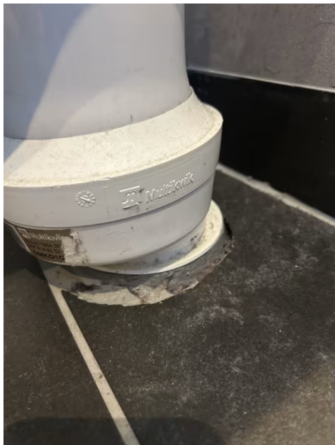
Manglende tetting rundt avløp til wc.
