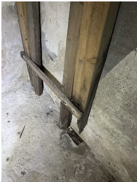
Skader på trapp.
