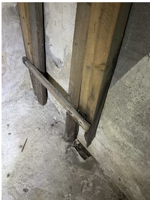
Råte på treverk i kjeller.
