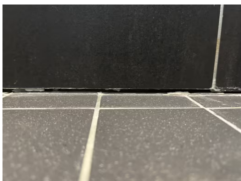
Manglende tetting mellom gulv og sokkelflis.
