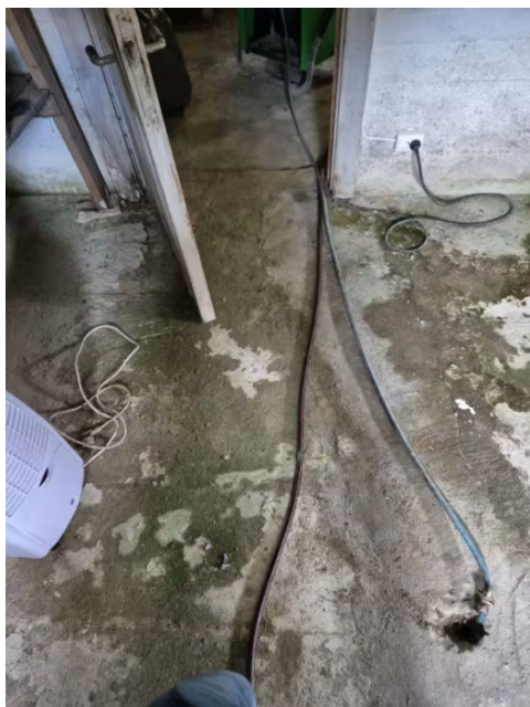
Hull i avløpsrør.
