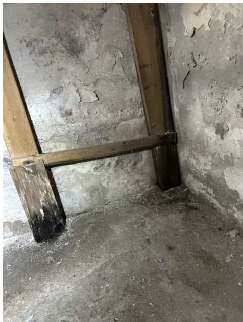
Skader på innside i kjeller.
