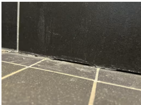
Manglende tetting mellom gulv og sokkelflis.
