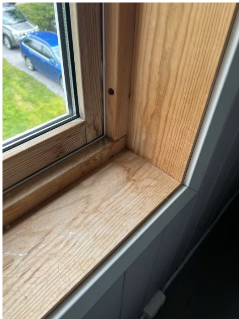
Fuktmerker i vindu.
