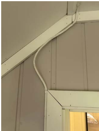
Utilstrekkelig festet kabel.
