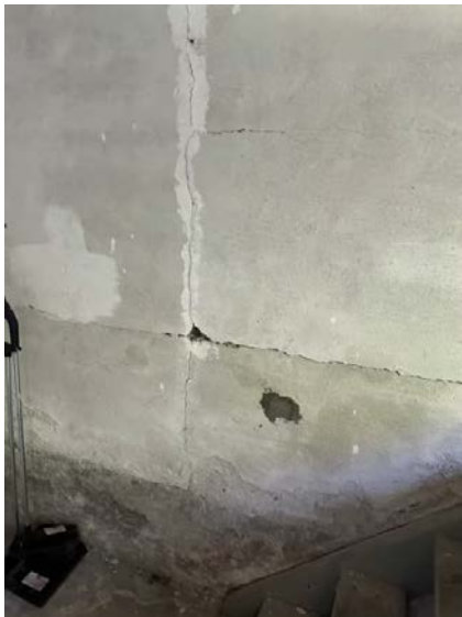
Sprekker i ringmur.
