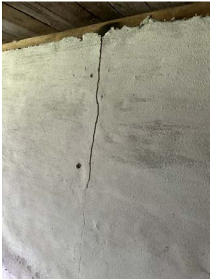
Sprekker i ringmur.
