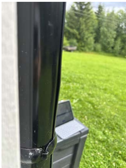
Frostspreg i nedløp.
