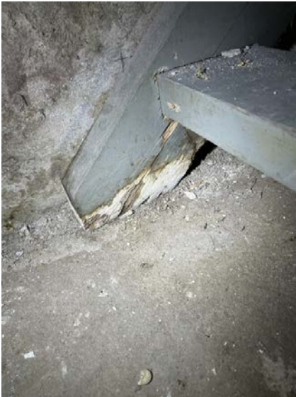
Råte på treverk i kjeller.
