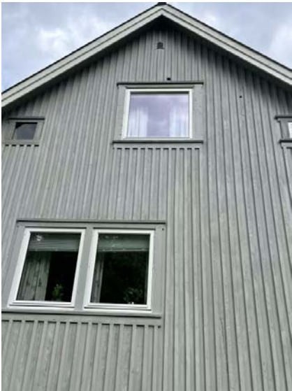
Overflatebehandling bør utføres.
