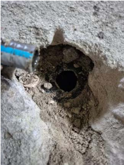
Hull i avløpsrør.
