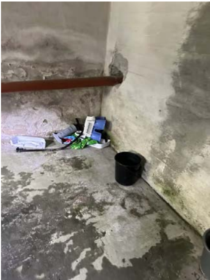
Fukt i kjeller vegg og gulv.
