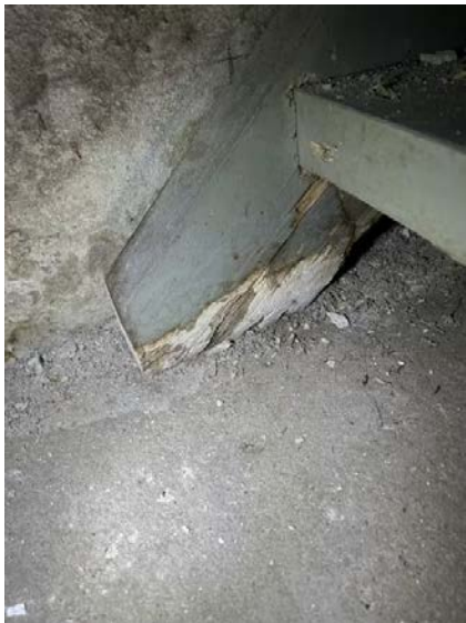
Skader på trapp.
