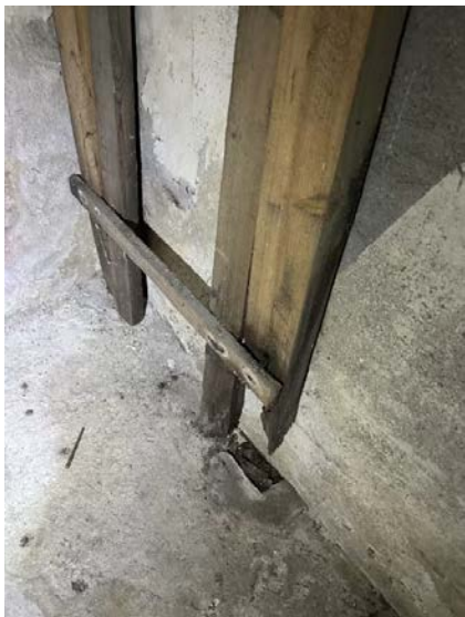
Råte på treverk i kjeller.
