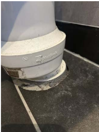
Manglende tetting rundt avløp til wc.
