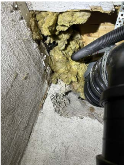
Ikke tett ordentlig etter oppgradering.
