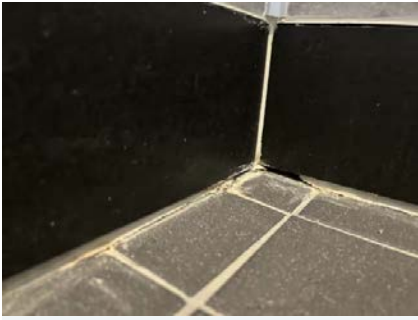
Manglende tetting mellom gulv og sokkelflis.
