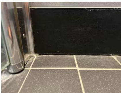
Manglende tetting mellom gulv og sokkelflis.
