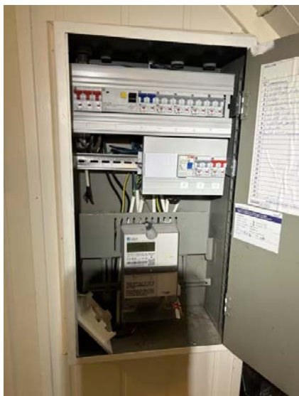
Sikringsskap med løse kabler
