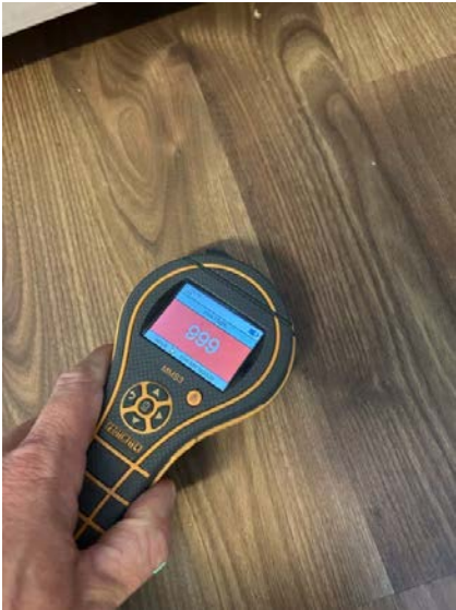
Fuktsøk ved oppvaskmaskin.
