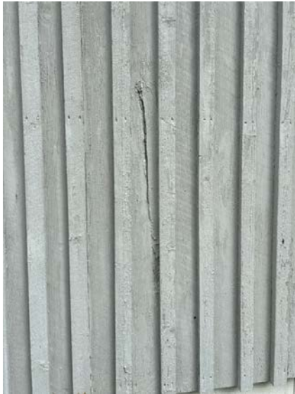
Sprekker i utvendig kledning.
