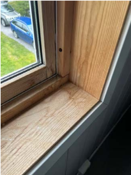
Fuktmerker i vindu.
