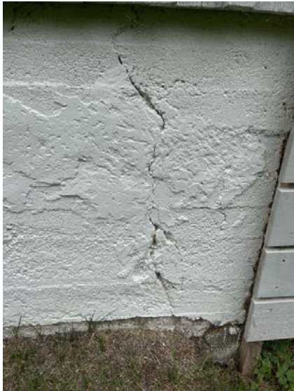
Sprekker i ringmur.
