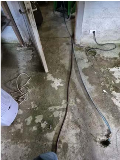
Hull i avløpsrør.
