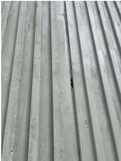
Sprekker i utvendig kledning.
