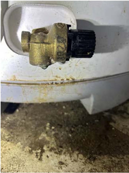
Drypplekkasje fra bereder.
