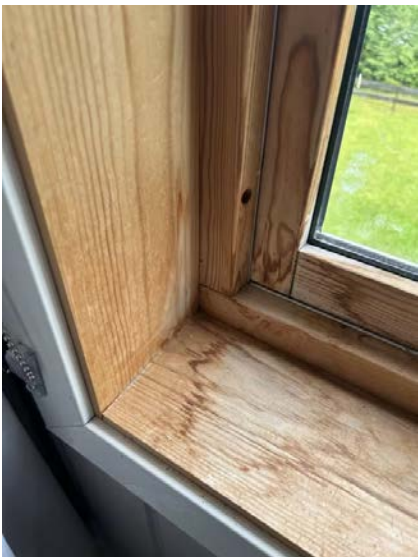
Fuktmerker i vindu.
