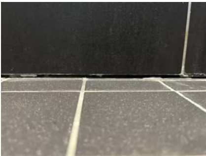
Manglende tetting mellom gulv og sokkelflis.
