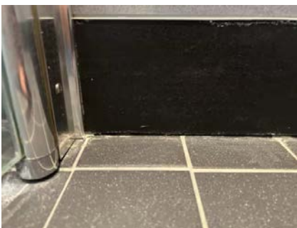
Manglende tetting mellom gulv og sokkelflis.
