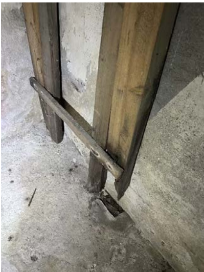
Råte på treverk i kjeller.
