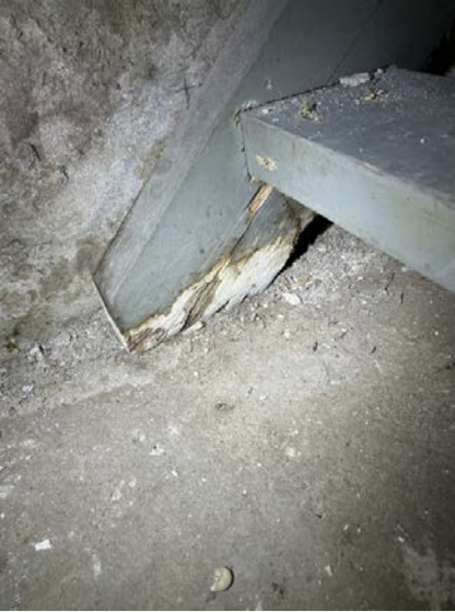
Råte på treverk i kjeller.
