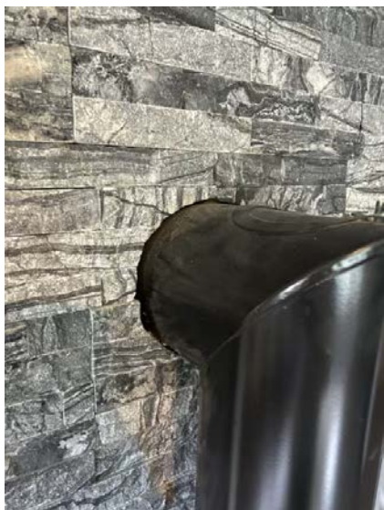
Manglende dekking rundt røykrør.
