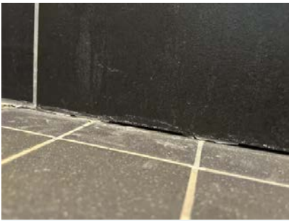
Manglende tetting mellom gulv og sokkelflis.
