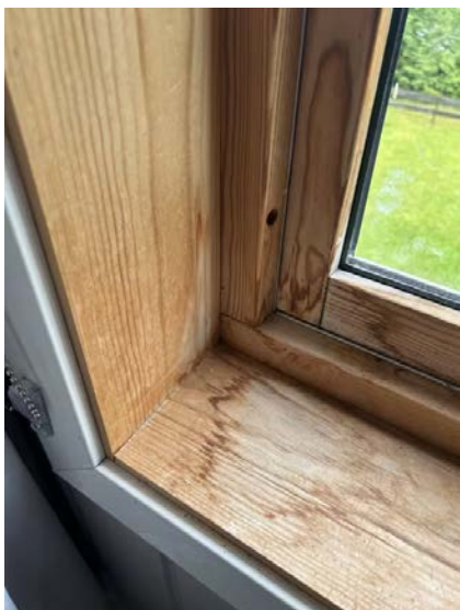
Fuktmerker i vindu.
