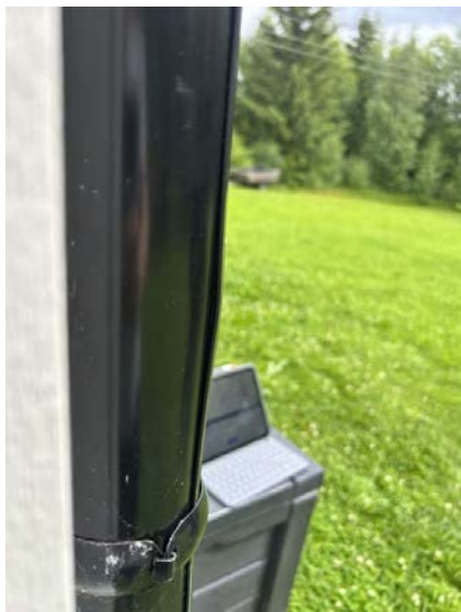
Frostspreg i nedløp.
