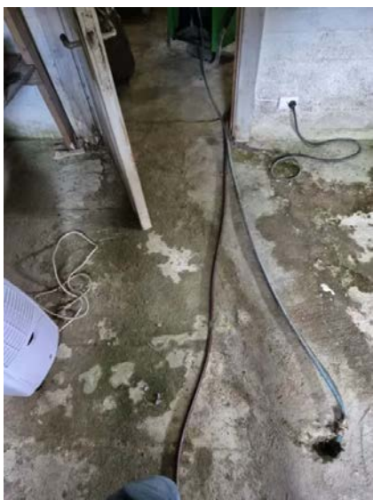
Hull i avløpsrør.
