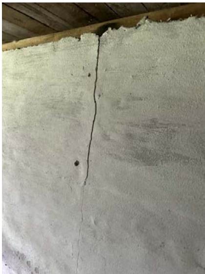
Sprekker i ringmur.
