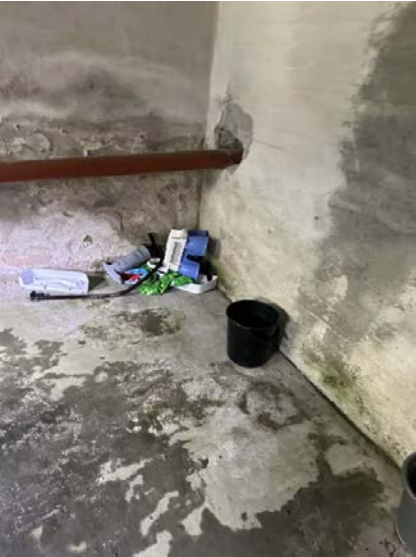
Fukt i kjeller vegg og gulv.
