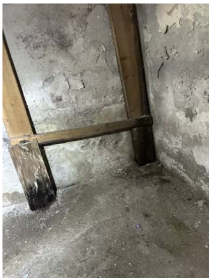
Skader på innside i kjeller.
