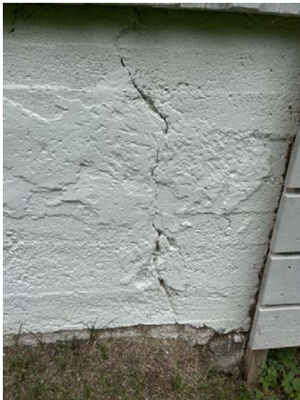
Sprekker i ringmur.
