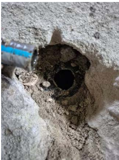
Hull i avløpsrør.
