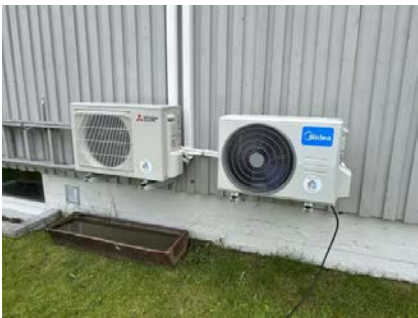
Utvendig del til varmepumpe.
