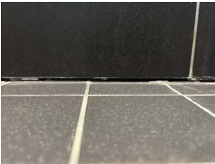
Manglende tetting mellom gulv og sokkelflis.
