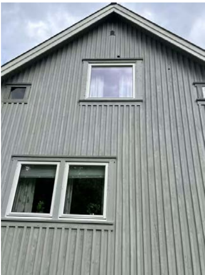
Overflatebehandling bør utføres.
