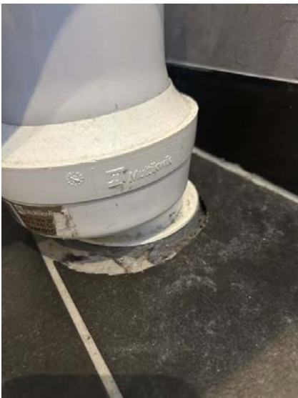
Manglende tetting rundt avløp til wc.
