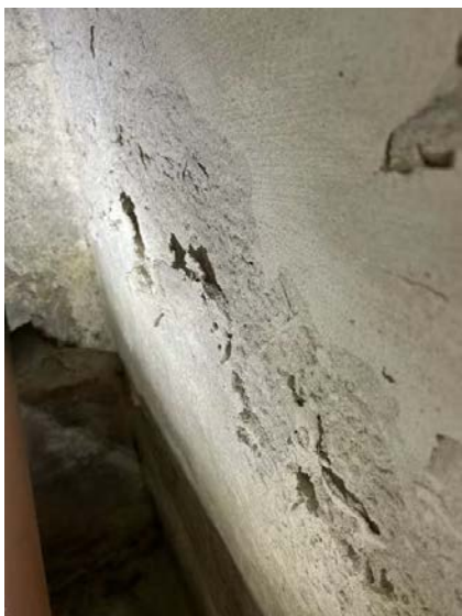
Saltutslag på vegger.
