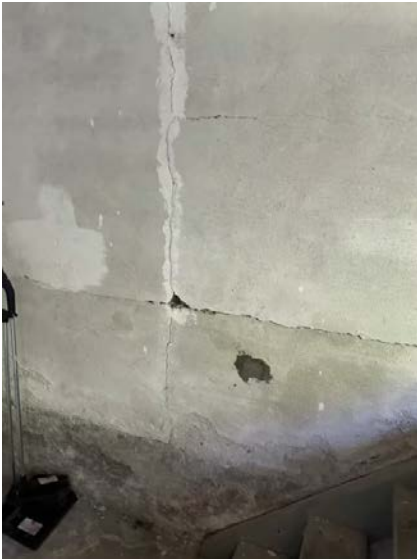
Sprekker i ringmur.
