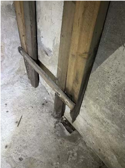
Skader på trapp.
