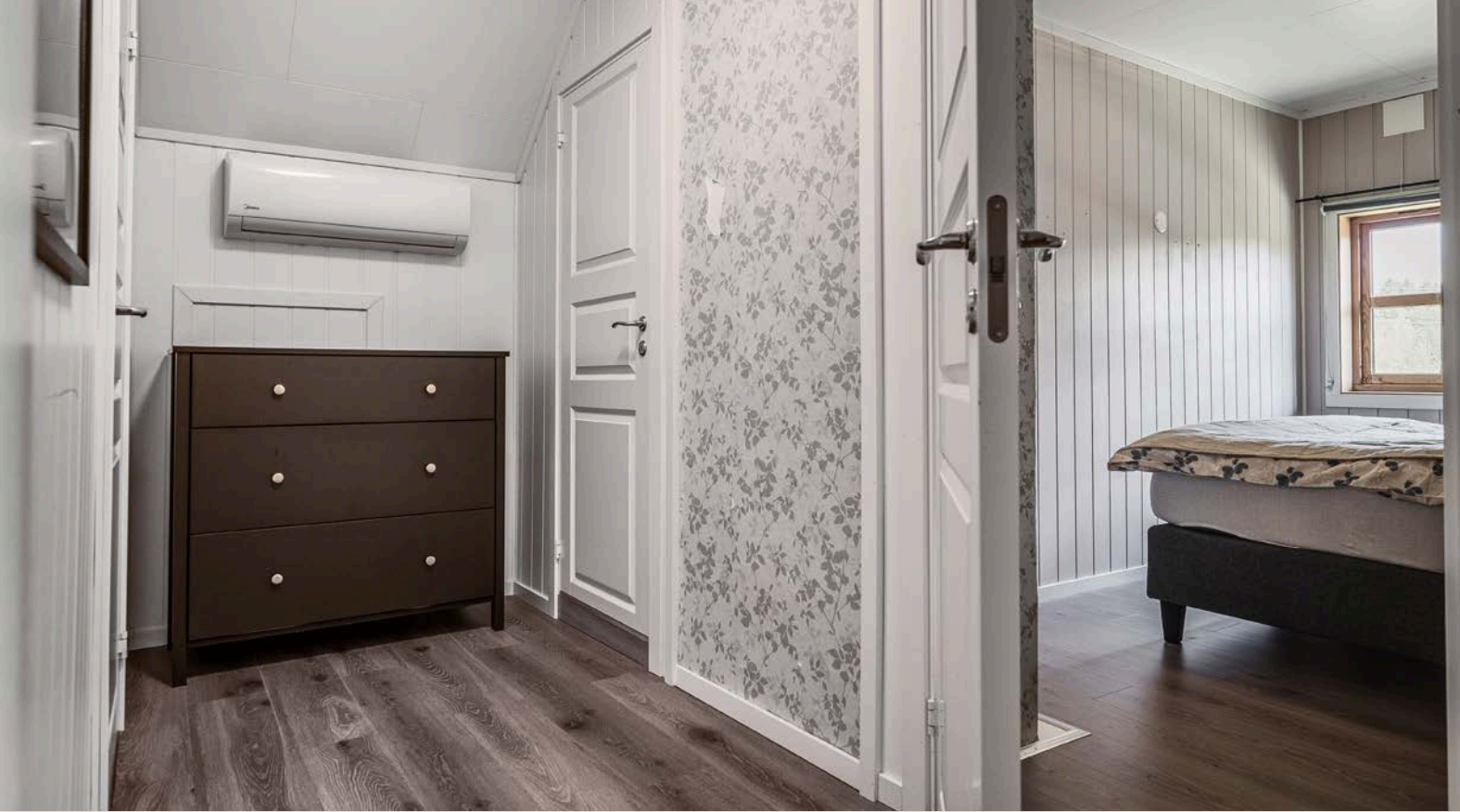
Gang/trapperom i 2. etasje. I likhet med stuen ble det også montert luft-til-luft varmepumpe her i 2022.
