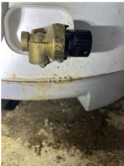
Drypplekkasje fra bereder.
