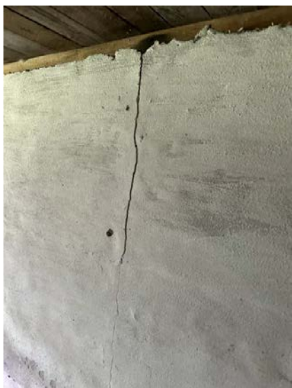
Sprekker i ringmur.
