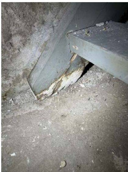
Råte på treverk i kjeller.
