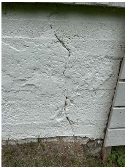
Sprekker i ringmur.
