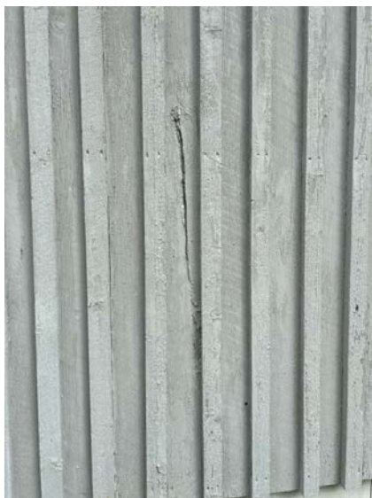
Sprekker i utvendig kledning.
