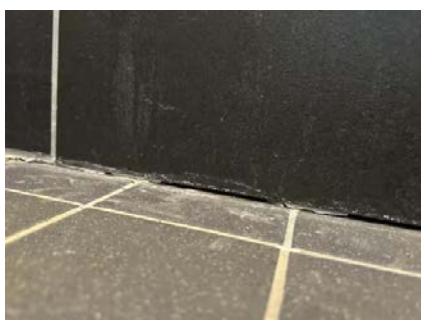
Manglende tetting mellom gulv og sokkelflis.
