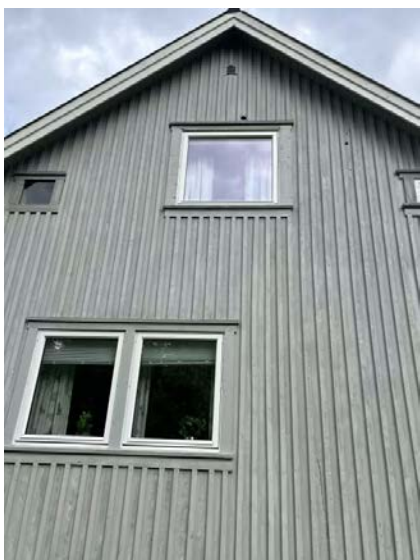
Overflatebehandling bør utføres.
