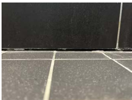
Manglende tetting mellom gulv og sokkelflis.
