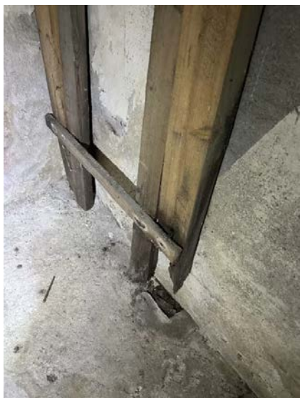
Råte på treverk i kjeller.
