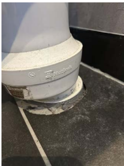
Manglende tetting rundt avløp til wc.
