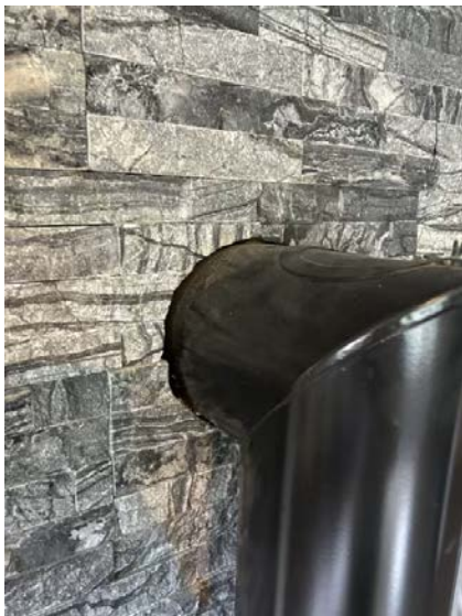
Manglende dekkring rundt røykrør.
