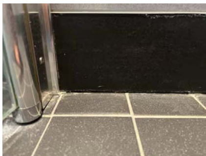
Manglende tetting mellom gulv og sokkelflis.
