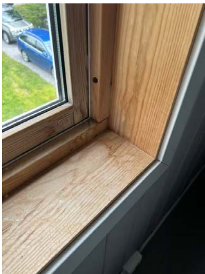
Fuktmerker i vindu.
