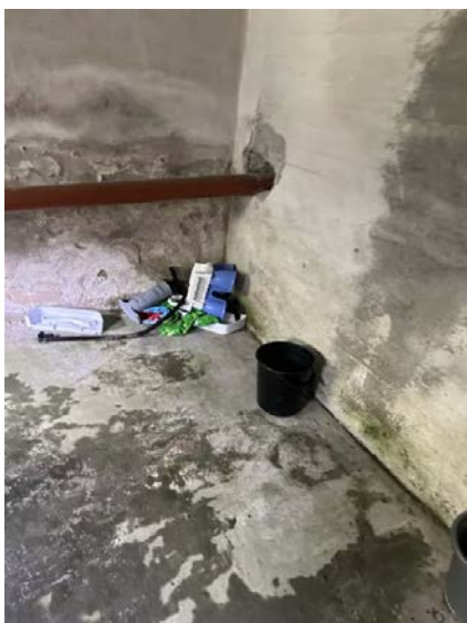
Fukt i kjeller vegg og gulv.
