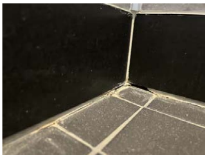
Manglende tetting mellom gulv og sokkelflis.
