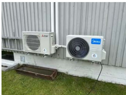
Utvendig del til varmepumpe.
