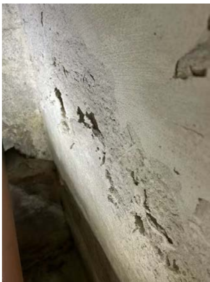
Saltutslag på vegger.
