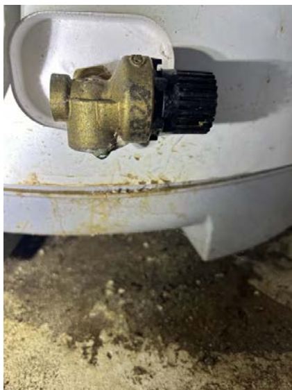
Drypplekkasje fra bereder.
