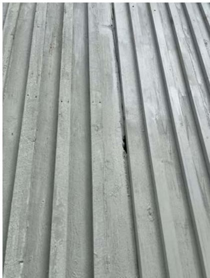
Sprekker i utvendig kledning.
