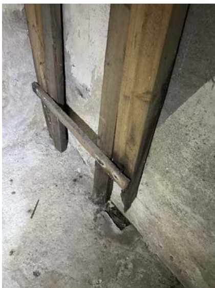
Skader på trapp.
