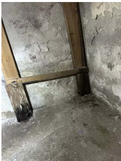
Skader på innside i kjeller.
