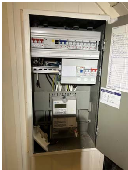
Sikringsskap med løse kabler
