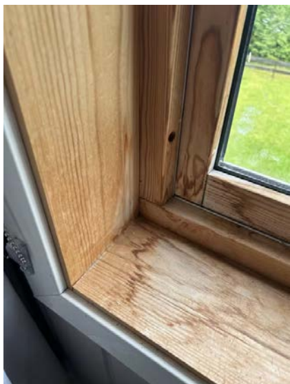
Fuktmerker i vindu.
