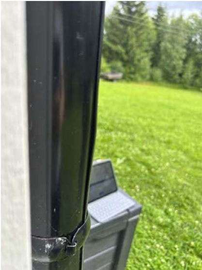
Frostspreng i nedløp.
