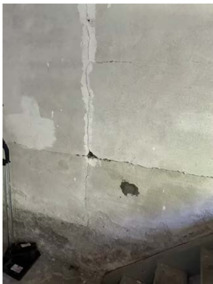
Sprekker i ringmur.
