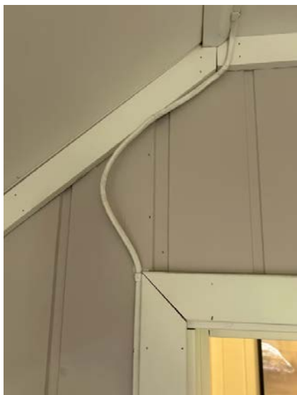
Utilstrekkelig festet kabel.
