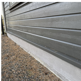
Liten/ingen lufting i bunnen av kledningen
