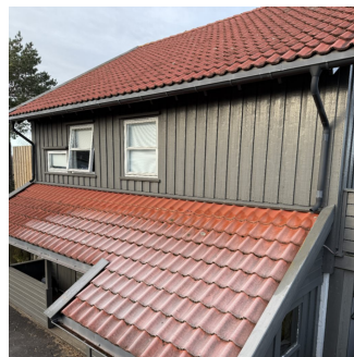
Manglende snøfanger og stigetrinn til pipe.
