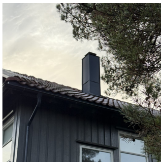
Manglende snøfanger og stigetrinn til pipe.
