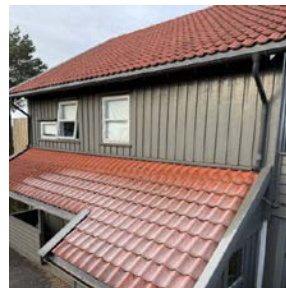
Manglende snøfanger og stigetrinn til pipe.
