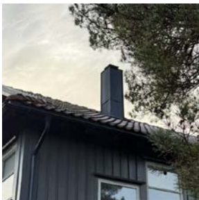
Manglende snøfanger og stigetrinn til pipe.
