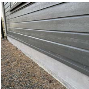
Liten/ingen lufting i bunnen av kledningen
