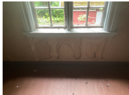
Fuktskjolder på innvendige vegger.
