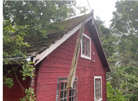
Takkonstruksjon med råte.
