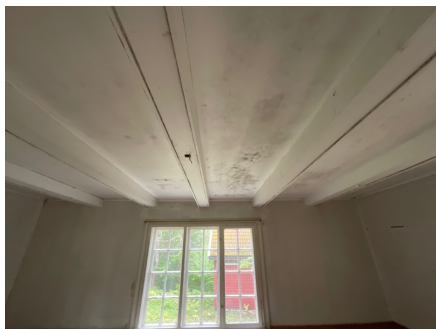
Muggsopp på innvendige overflater.
