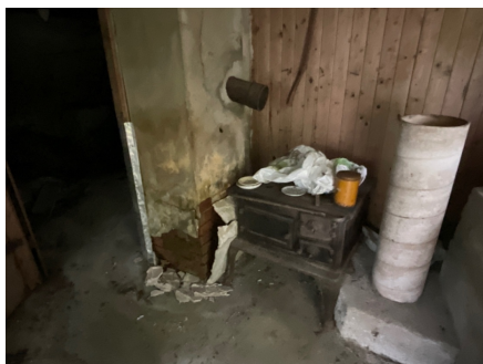
Vedovn i kjeller. Ikke koblet til pipe.
