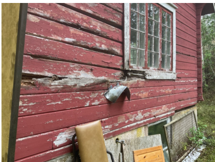
Råte på utvendige vegger.
