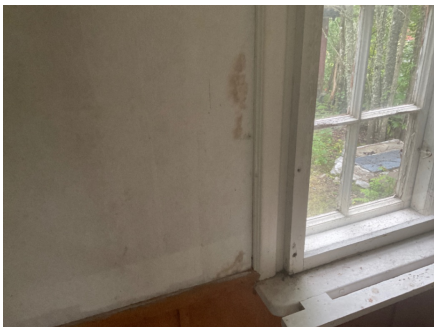
Fuktskjolder på innvendige vegger.
