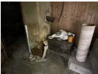
Vedovn i kjeller. Ikke koblet til pipe.
