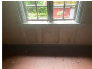
Fuktskjolder på innvendige vegger.
