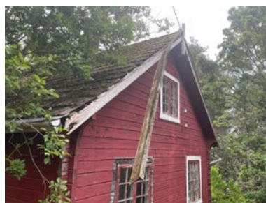
Takkonstruksjon med råte.
