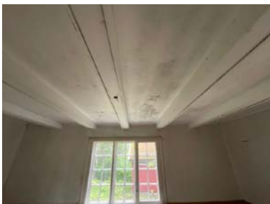
Muggsopp på innvendige overflater.
