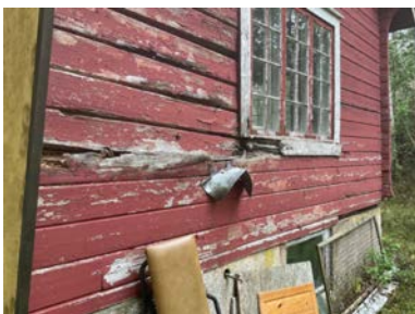
Råte på utvendige vegger.
