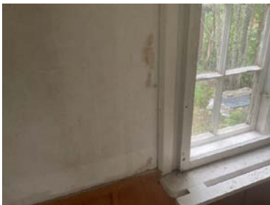
Fuktskjolder på innvendige vegger.
