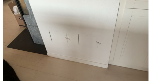
Ildfast plate mangler på gulvet under sotluke/feieluke på pipe.
