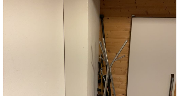
Luftespalte er tettet og hindrer fri luft gjennomstrømning rundt kjølerom.
