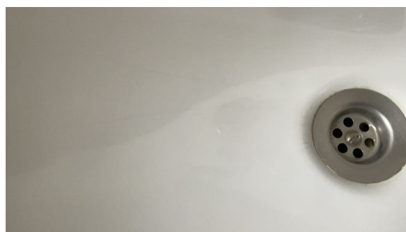
Det er påvist riss/sprekker i servant.
