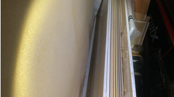
Det er påvist skade/svelling som følge av fukt.
