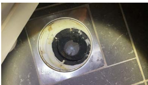
Sluket uten klemring på membranen. Det kan fort bli problematisk om sluket tetter seg. Da kan vann trenge inn under membran.
