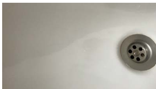
Det er påvist riss/sprekker i servant.
