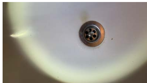
Det er påvist riss/sprekker i servant.
