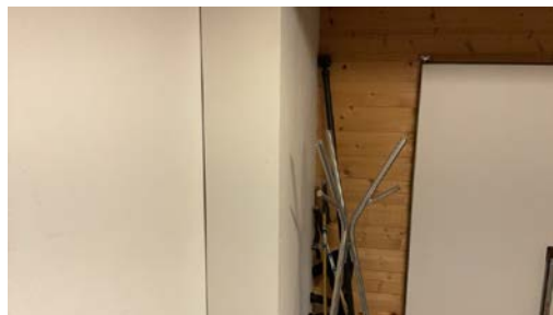
Luftespalte er tettet og hindrer fri luft gjennomstrømning rundt kjølerom.
