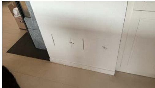
Ildfast plate mangler på gulvet under sotluke/feieluke på pipe.
