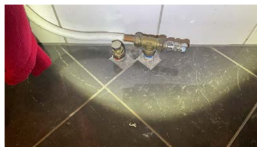
Utilfredstillende tetting ved rørgjennomganger
