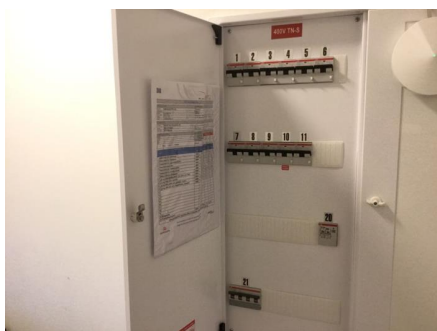
Sikringskap plassert i gang 1. etasje.
