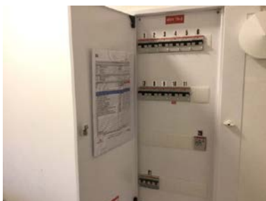
Sikringsskap plassert i gang 1. etasje.
