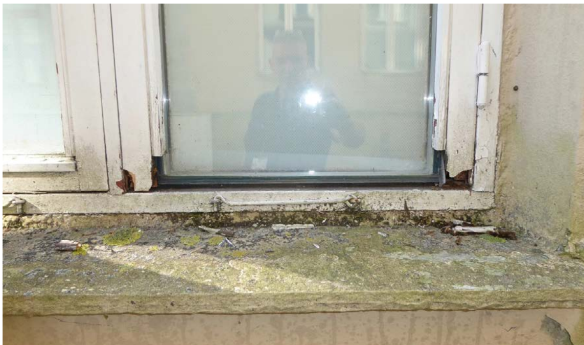
Nærbilde av skadet ramme på vindu, der bunnstykket har falt ut.
