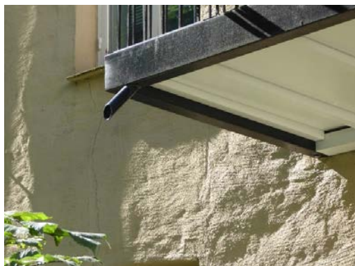
Utvendig avkast for avrenning av regnvann.
