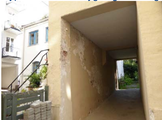
Pusskader på vegg ved portrom i bakgårdsbygg.
