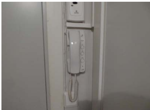
Innvendig dørtelefon med styring av callinganleg.
