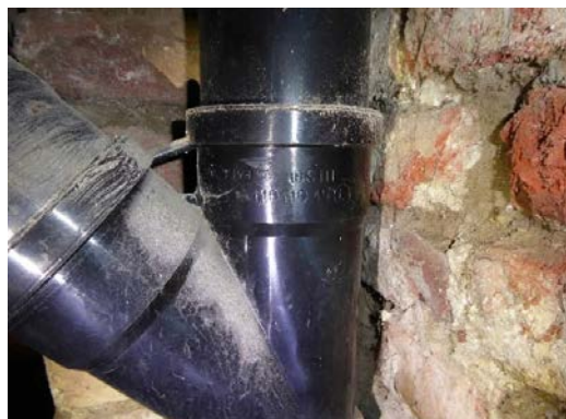
Avløpsrør av ABS plast i kjeller.
