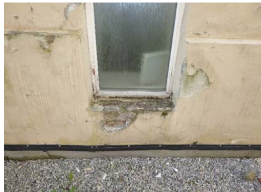
Pusskade under vindu.
