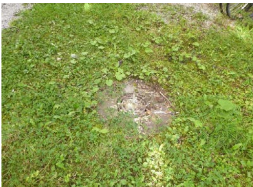
Overvannskum i bakgård mellom bygg A og B.
