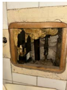
Røropplegg under servant på bad.
