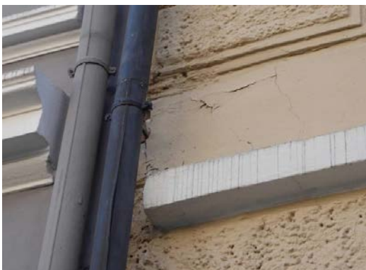
Pusskade på fasade mot gate.
