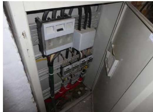
Hovedtavle med hovedinntak og fordeling til underskap.
