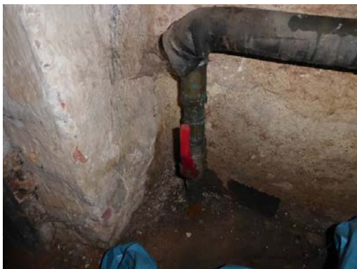
Nyere kuleventil som hovedstoppekran i en av oppgangene.
