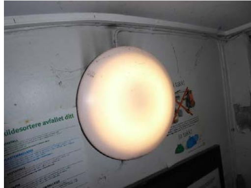
Lysarmatur i trappeoppgang med LED lyskilde.
