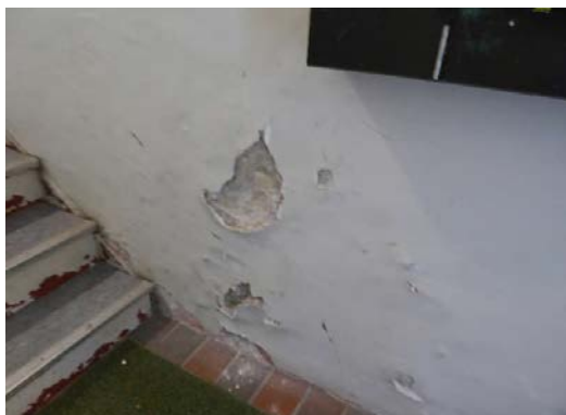
Pusskader på vegg i trappeoppgang.
