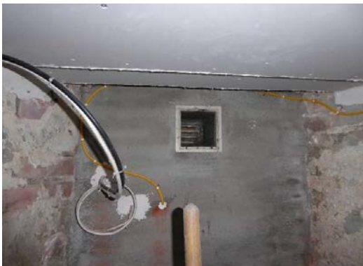
Lufteventil i yttervegg – kjeller.
