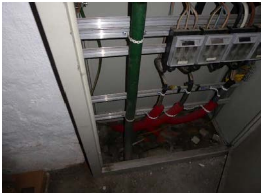
Nyere inntakskabel – den grønne.
