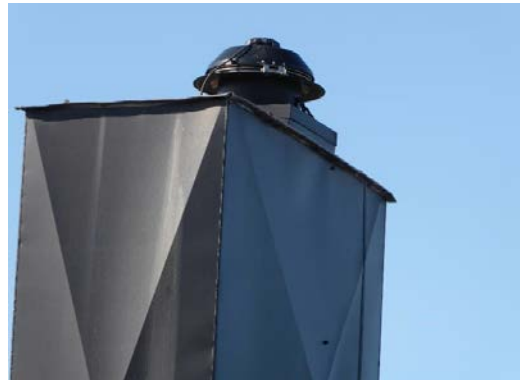
Ventilasjonsaggregat påmontert toppen av luftesjakt over tak.
