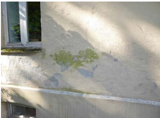
Pusskader på fasade.
