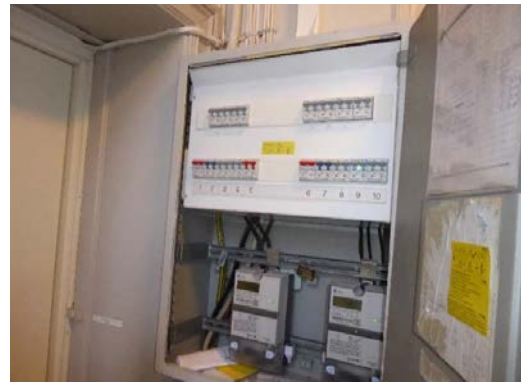
Underfordeling til boliger i oppgang A
