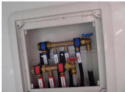
Eksempel på moderne vannrør og stoppekraner i bolig.
