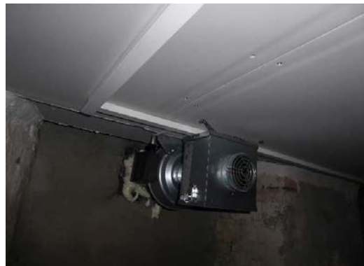
Avtrekksvifte i kjeller.
