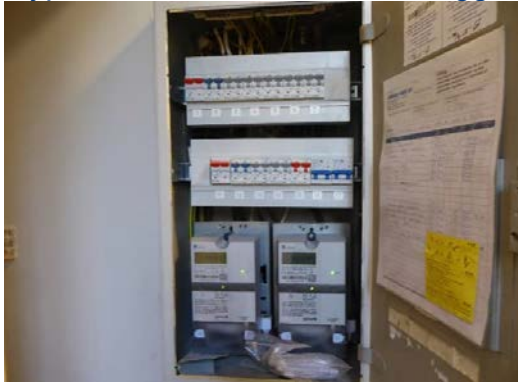
Underfordeling til leiligheter i oppgang B.
