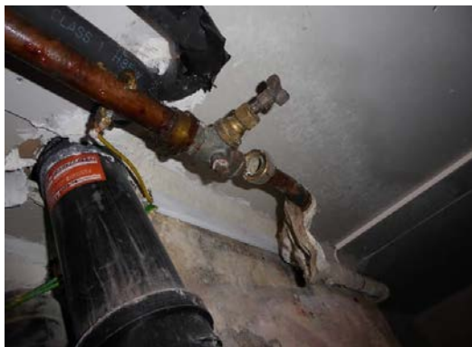
Vannrør på fellesområder.
