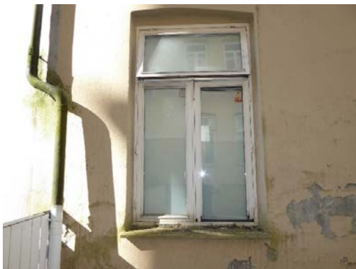
Vindu med skader på ramme.
