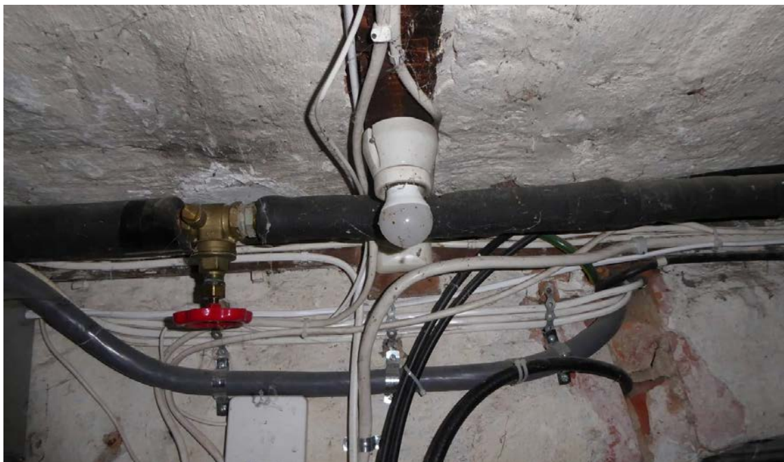
Lyskilde med porselenssokkel i kjeller.
