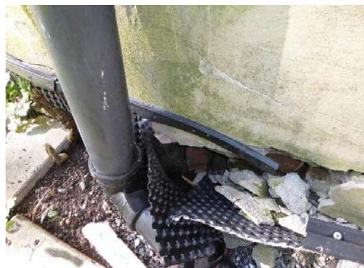
Manglende tetting av Platon, samt skade på grunnmur.
