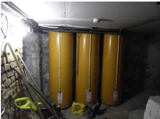
Varmtvannsberedere i oppgang B.
