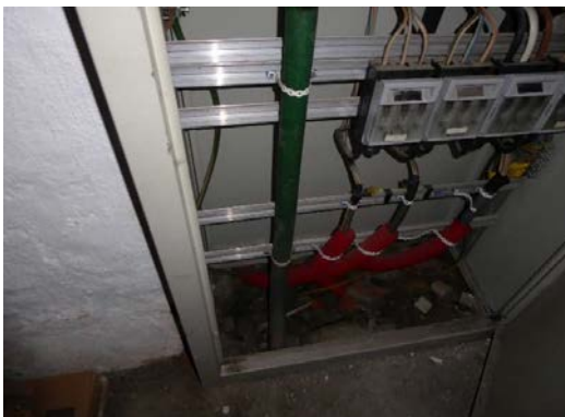
Nyere inntakskabel – den grønne.
