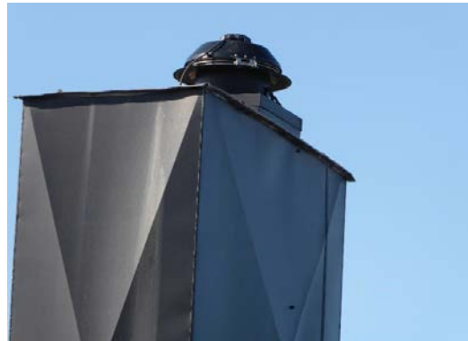
Ventilasjonsaggregat påmontert toppen av luftesjakt over tak.
