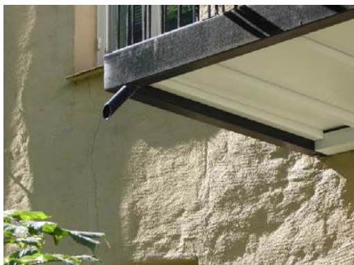
Utvendig avkast for avrenning av regnvann.
