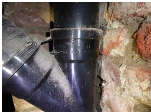
Avløpsrør av ABS plast i kjeller.
