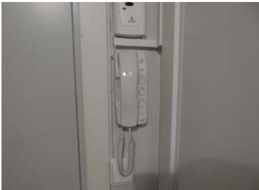
Innvendig dørtelefon med styring av callinganlegget.
