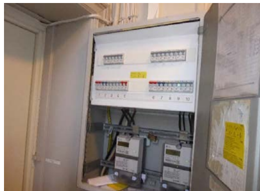
Underfordeling til boliger i oppgang A
