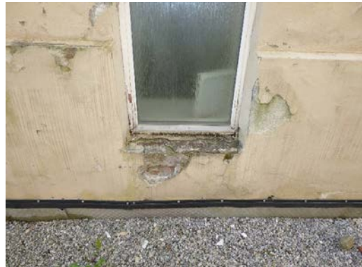
Pusskade under vindu.
