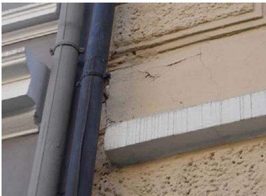
Pusskade på fasade mot gate.
