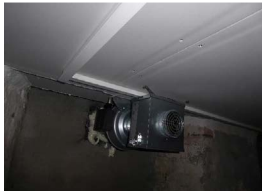
Avtrekksvifte i kjeller.
