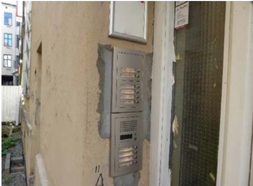
Utvendig ringetabla for callinganlegget.
