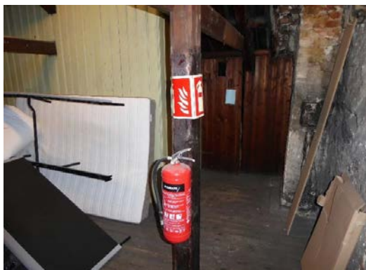
Brannslukker med merking på loft.
