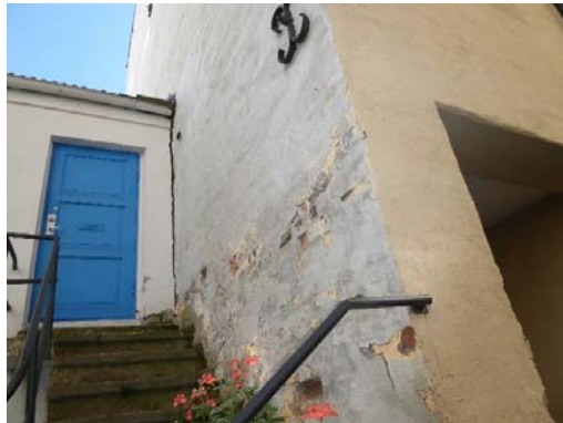
Antatt årsak til pusskader på vegg i forrige bilde.
