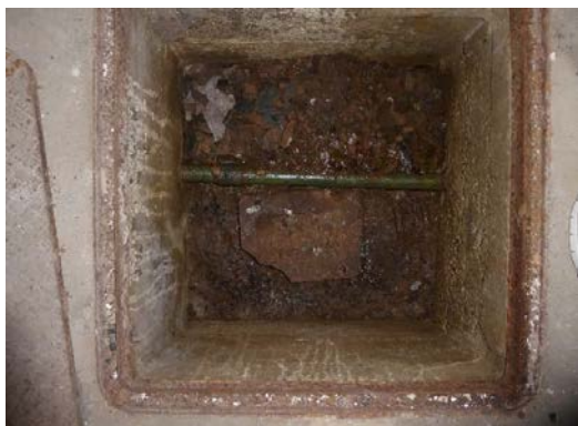
Vanninnlegg og bunnledning i stakekum.
