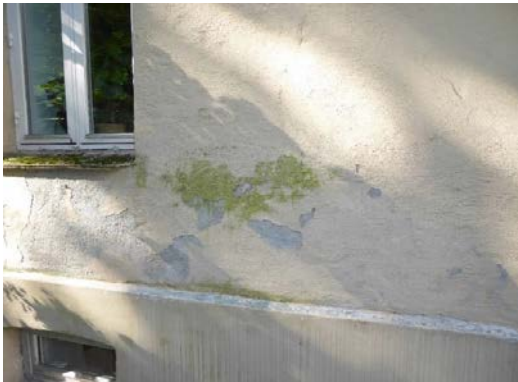
Pusskader på fasade.
