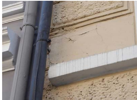
Nedløpsrør med «sprengt» fals.
