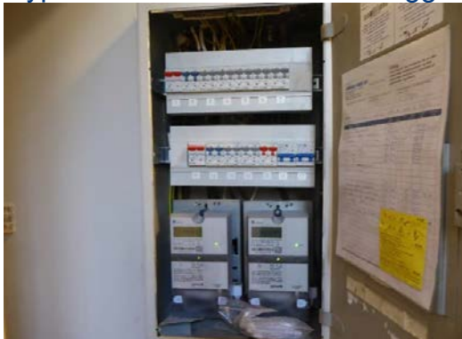
Underfordeling til leiligheter i oppgang B.
