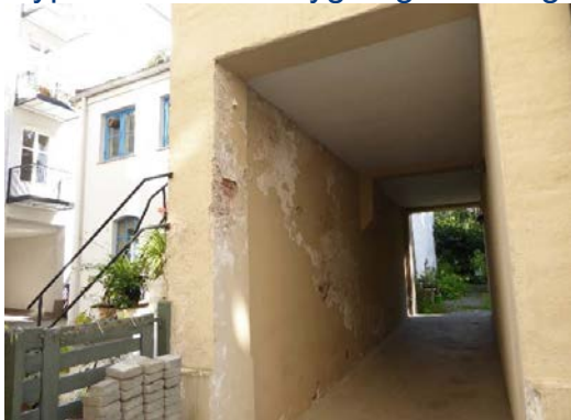
Pusskader på vegg ved portrom i bakgårdsbygg.
