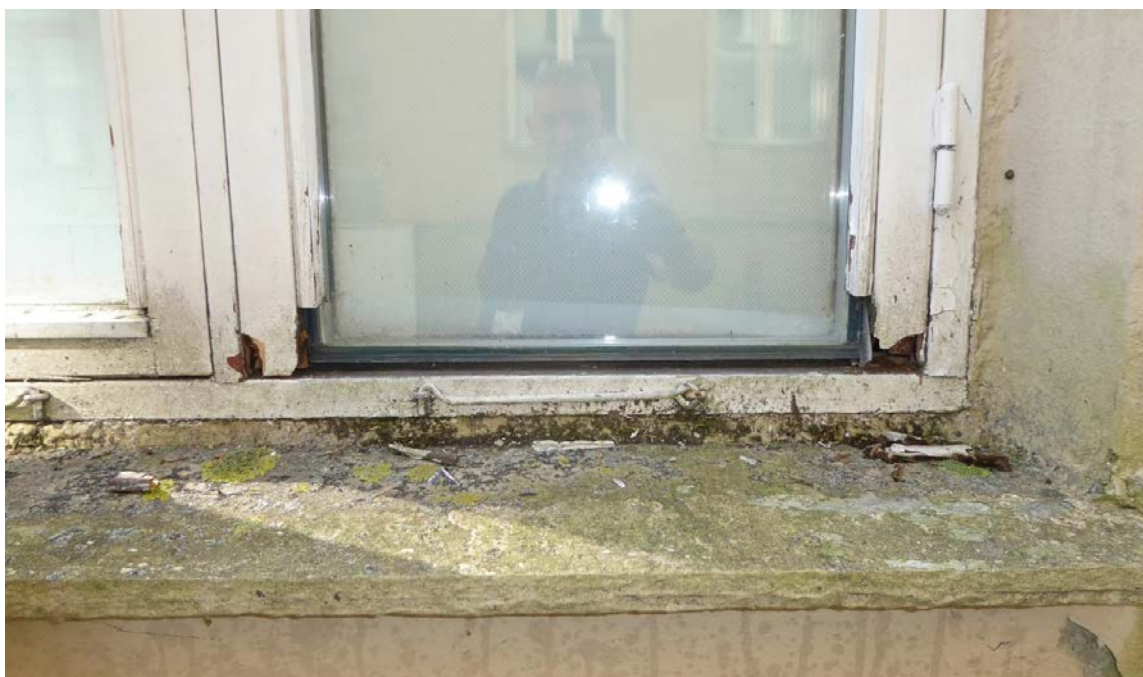
Nærbilde av skadet ramme på vindu, der bunnstykket har falt ut.
