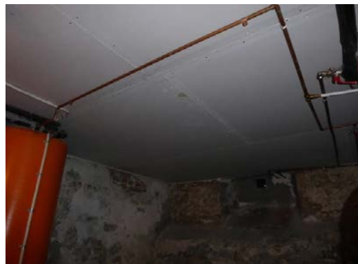
Uisolert rør fra bereder.
