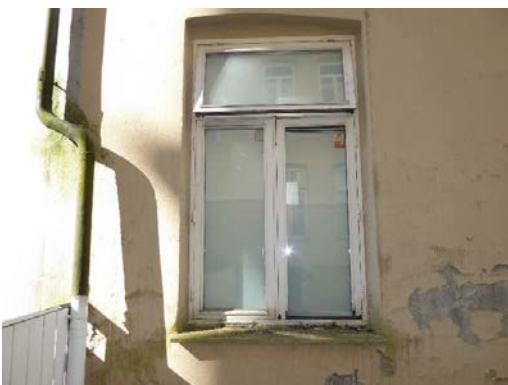
Vindu med skader på ramme.
