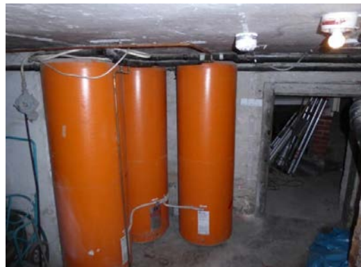
Varmtvannsberedere i oppgang A.
