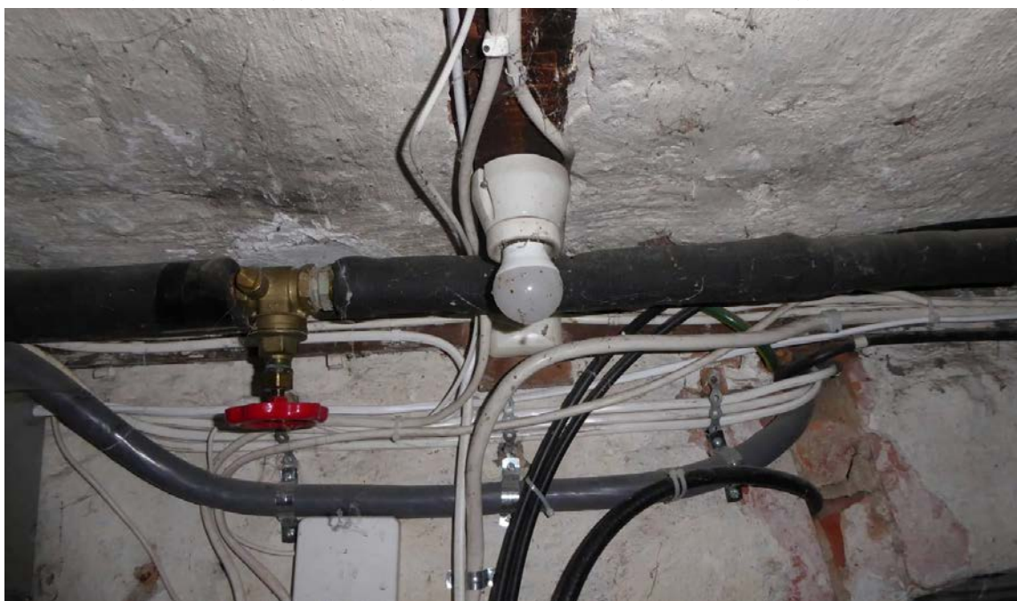
Lyskilde med porselenssokkel i kjeller.
