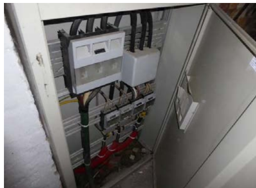
Hovedtavle med hovedinntak og fordeling til underskap.
