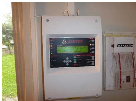
Brannvarslingssentral i oppgang.
