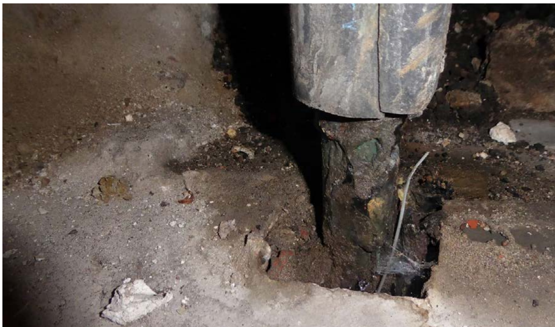
Kondensering på vannrør gir mye fuktighet, spesielt i sommerhalvåret. Viktig med god isolering av alle vannrør.
