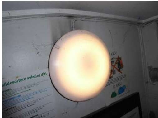
Lysarmatur i trappeoppgang med LED lyskilde.
