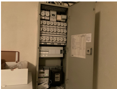
Sikringsskap i bildene i kjelleren
