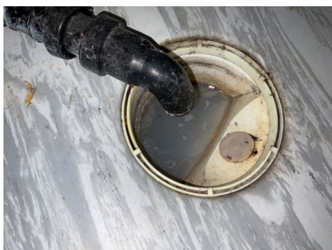
Sluk på vaskerom
