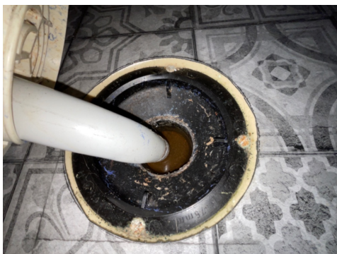
Sluk på badet rom 2. etasje
