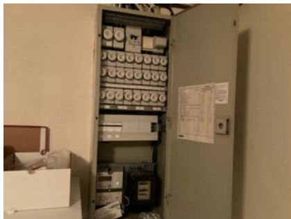
Sikringsskap i bildene i kjelleren
