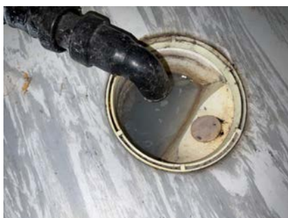
Sluk på vaskerom
