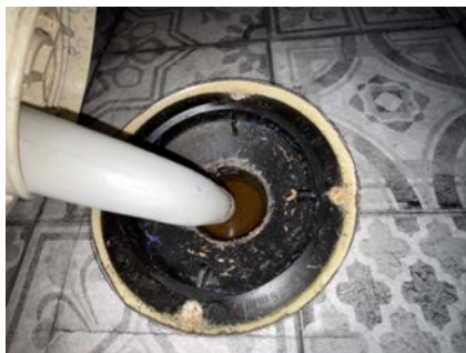
Sluk på baderom 2. etasje
