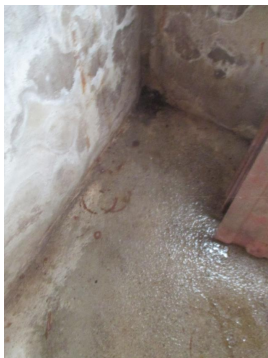
Innsig av vann og fuktmerker på grunnmur.
