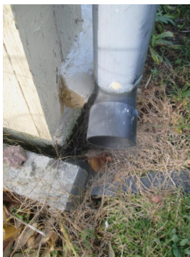
Vann i fra taknedløp må ledes bort i fra grunnmur.
