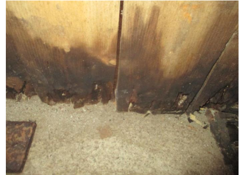
Har trukket opp fuktighet i skillevegger.
