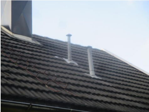
Piper er blitt helbeslått etter lekkasjer.
