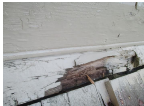
Noe råteskader på bunnstokk.
