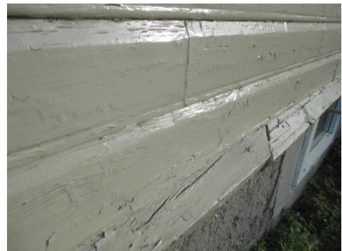
Lite tilgang på luft ved grunnmur.
