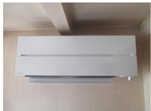
Varmepumpe i stue.
