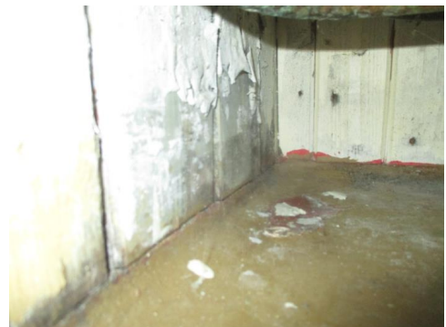
Skader på panel under badekar.
