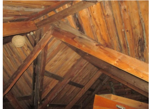
En del merker på undertaket av bord.
