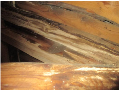
Skade på undertaket og bjelke etter lekkasje ved pipe.
