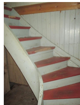
Malt kjellertrapp uten rekkverk.
