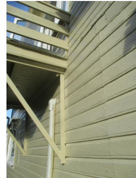
Skjevheter. Mulig balkong har dratt kledningen noe ut.
