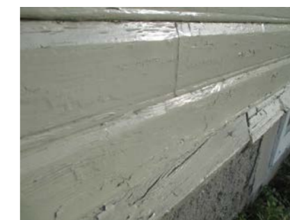
Lite tilgang på luft ved grunnmur.
