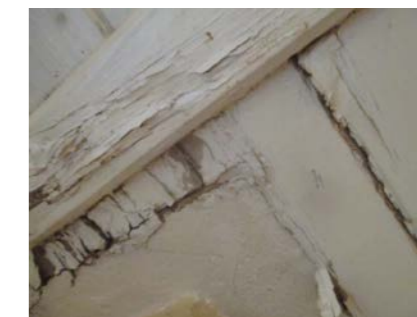
Rundt pipe i gangen.
