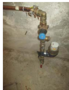
Innendig stoppekran med vannmåler er plassert i grovkjeller.
