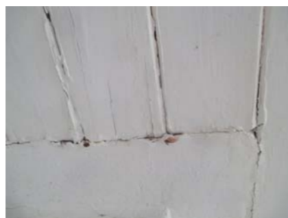
Rundt pipe på loftstue.
