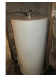
Berder er plassert i grovkjeller ved trapp.
