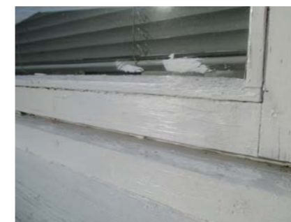
Noe slitasje på utvendig karm og ramme.
