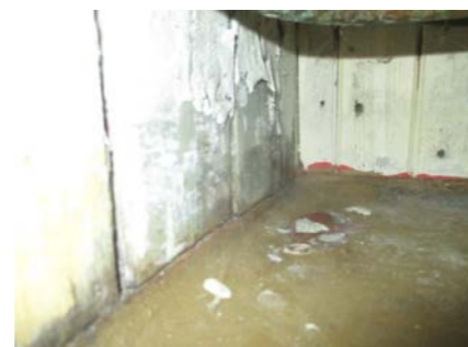
Skader på panel under badekar.
