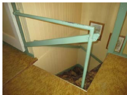
Store åpninger i rekkverk rundt trapp på loftet.
