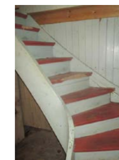
Malt kjellertrapp uten rekkverk.
