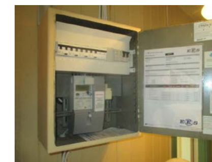
Sikringsskapet er plassert i gangen på loftet.
