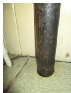
Avløpsrør i fra kjøkkenbenken.
