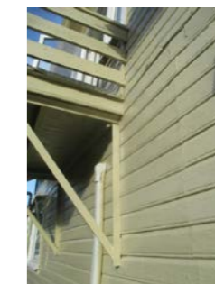
Skjevheter. Mulig balkong har dratt kledningen noe ut.
