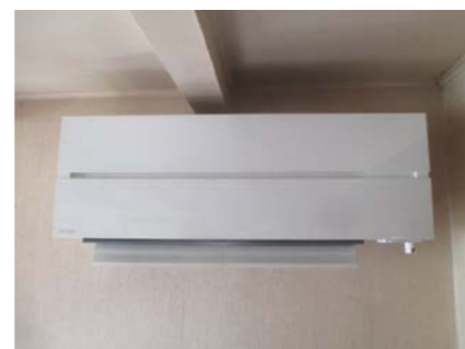
Varmepumpe i stue.
