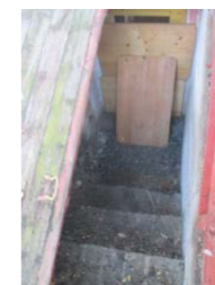
Defekt ytterdør og råteskader på kjellerlemmen
