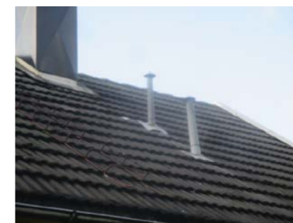
Piper er blitt helbeslått etter lekkasjer.
