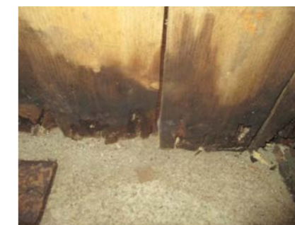
Har trukket opp fuktighet i skillevegger.
