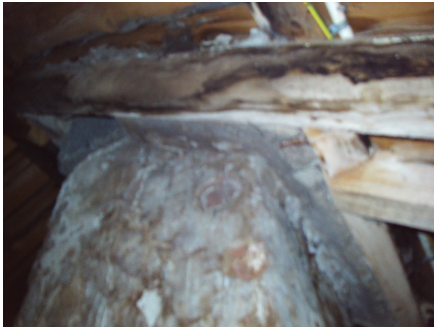
Eldre fuktskade/råte i rundt pipe.
