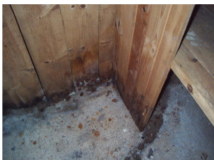
Har trukket opp fuktighet i skillevegger
