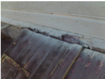
Noen råteskader enkelte plasser
