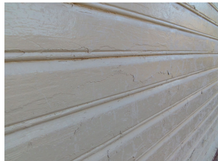
Kledningen er slitt.
