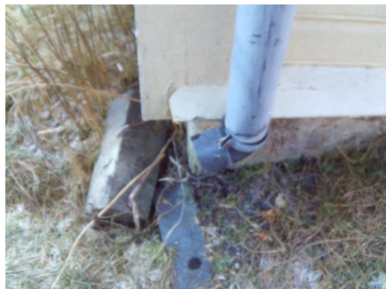
Takvann må ledes bort i fra grunnmur.
