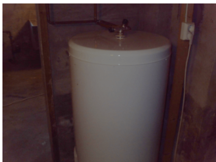
Bereder er plassert i grovkjeller.
