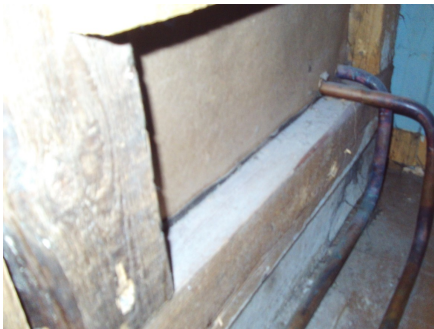
Fuktmåling i fra knekott.
