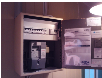
Sikringsskapet er plassert i gangen på loftet.
