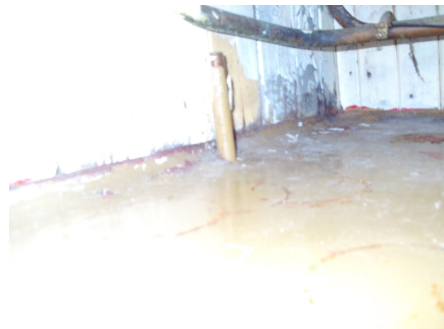
Skader på panel under badekar.
