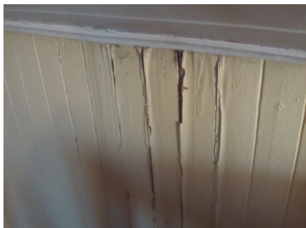
Skader i trappeoppgang.
