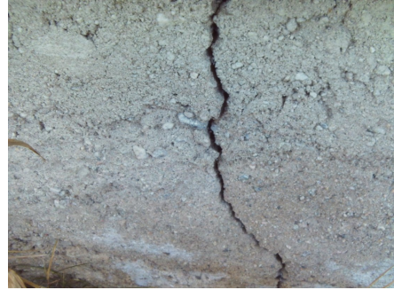
Noen sprekker flere plasser.
