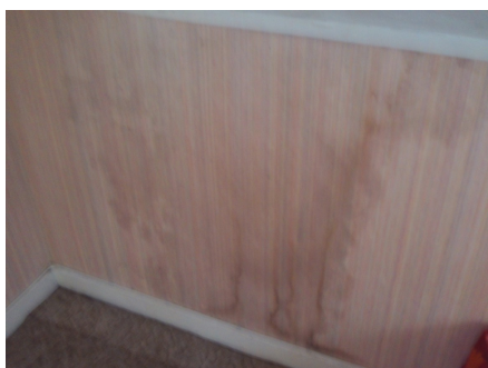
Fuktmerker på knevegg ene soverommet
