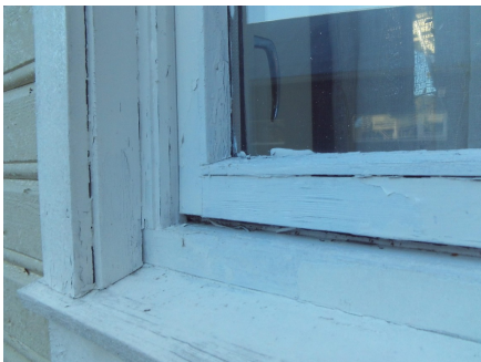
Noe slitasje på utvendig karm og ramme.
