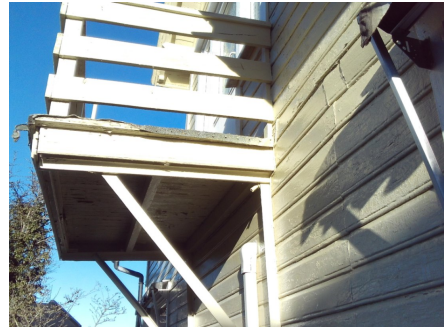
Større skjevheter ved balkong
