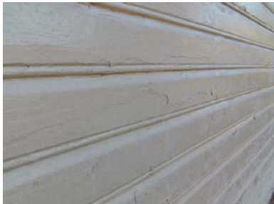
Kledningen er slitt.
