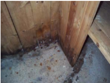
Har trukket opp fuktighet i skillevegger
