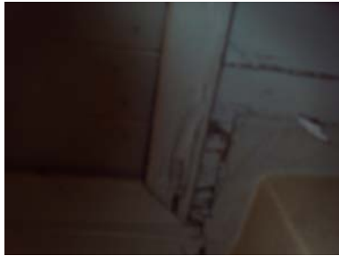
Gammel lekkasje i rundt pipe.
