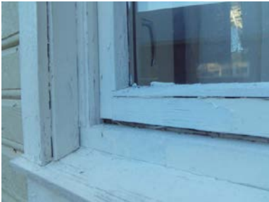
Noe slitasje på utvendig karm og ramme.
