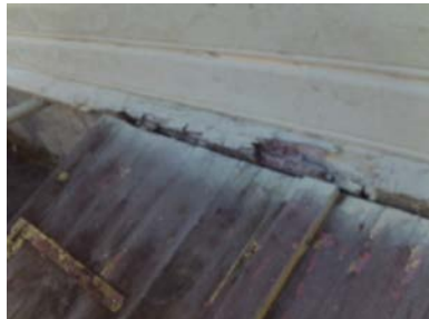
Noen råteskader enkelte plasser
