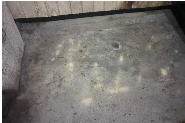
Støv etter borebiller i kjeller
