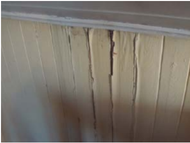
Skader i trappeoppgang.
