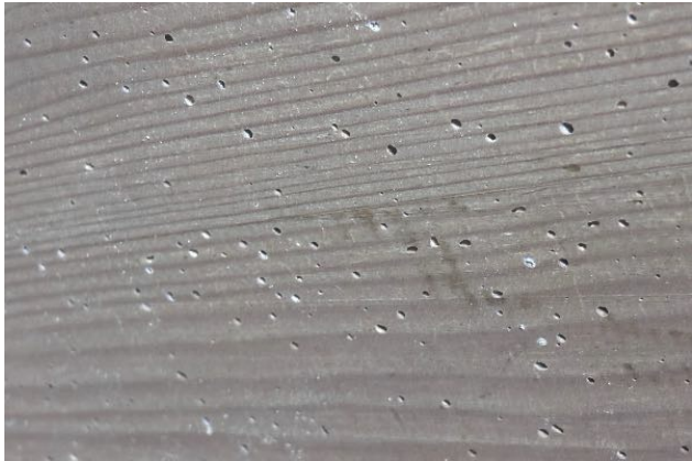
Hull etter borebiller i kjellertrapp
