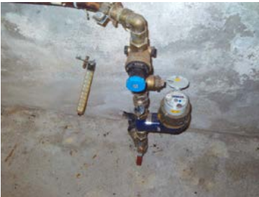
Innvendig stoppekran med vannmåler er plassert i grovkjeller.
