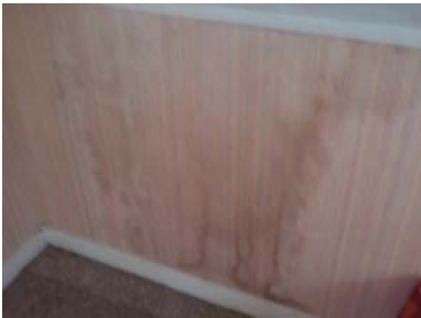
Fuktmerker på knevegg ene soverommet
