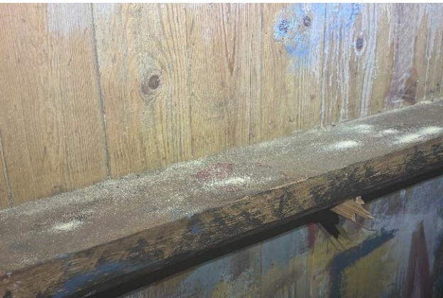
Støv etter borebiller
