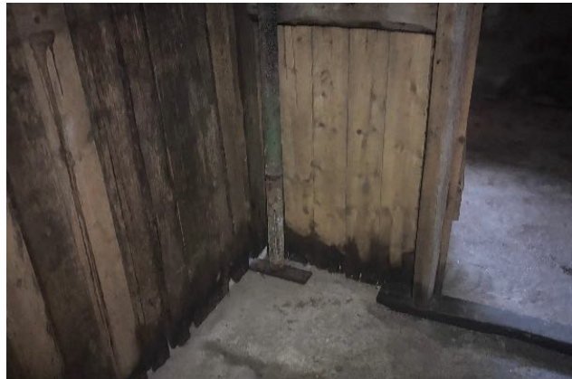
Fuktighet opp fra gulv
