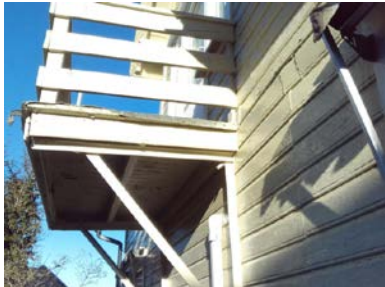
Større skjevheter ved balkong
