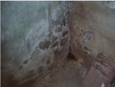
En del fuktmerker på grunnmur.
