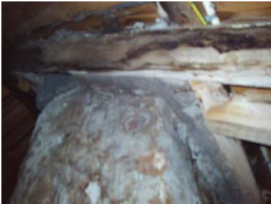
Eldre fuktskade/råte i rundt pipe.
