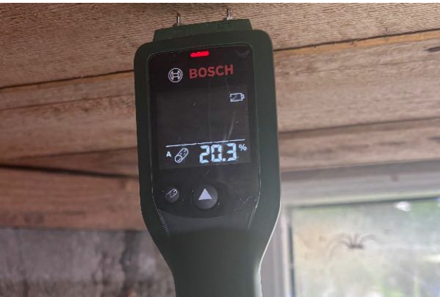
Fukt målt i kjellertak
