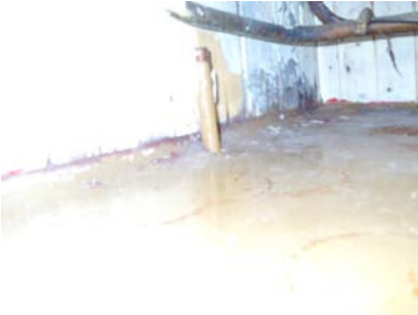
Skader påpanel under badekar.
