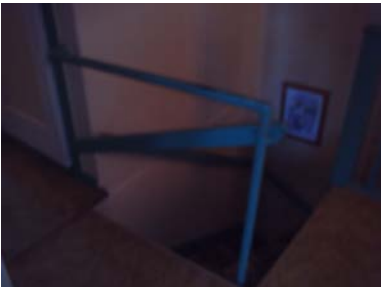
Ingen tilfredstillende sikring i rundt trapp.
