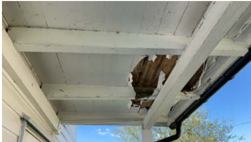
Store avflassinger av maling på undertak
