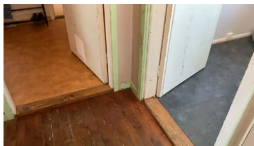
OOverflater har slitasjegrad utover det en kan forvente.
