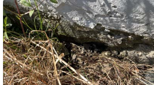
Mur er vasket bort under terreng.
