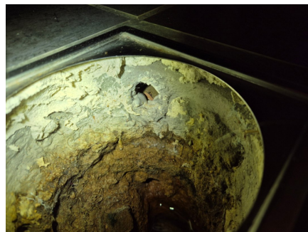
Støpejernsluk under vask, hull i siden.
