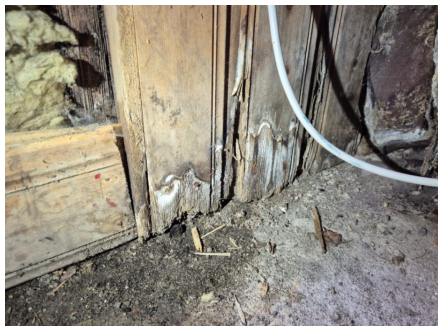
Krypkjeller 1. Tegn til fuktig miljø.
