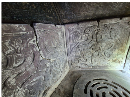
Sprekker i ildfast stein.
