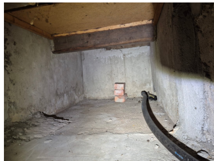
Krypkjeller 2. Ingen lufting.
