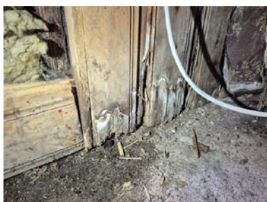
Krypkjeller 1. Tegn til fuktig miljø.
