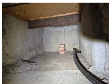
Krypkjeller 2. Ingen lufting.
