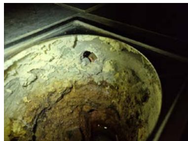
Støpejernsluk under vask, hull i siden.
