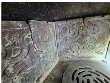
Sprekker i ildfast stein.
