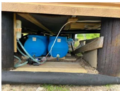
Forbrukstanker og pumpe
