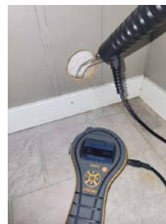
Fuktmåling i innforet trevegg i kjeller med forhøvede fuktverdier.
