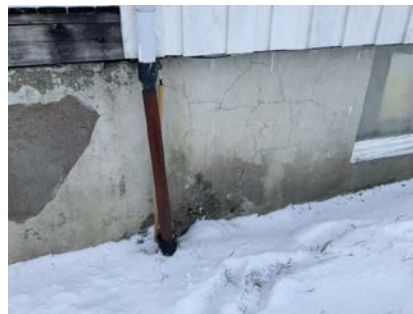
Avflassing av puss på mur mot sør.
