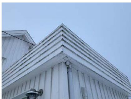
Ingen utvendig lufting inn i konstruksjonen
