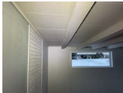
Skjevhet i himling på stue.
