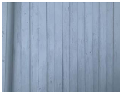
Kledning mot sør har sprekker i overflater.
