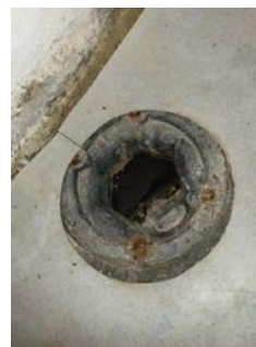
Soilsluk med rust på festeskruer og overflate.
