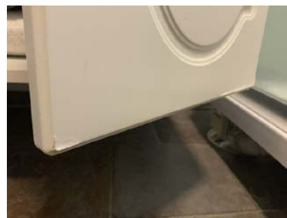
Fuktskade på innredning.
