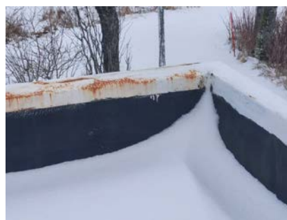
Rust på beslag på gesims.
