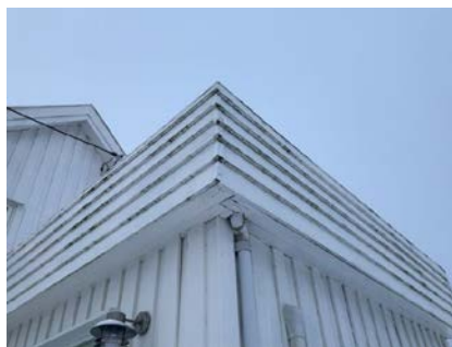
Eldre kledning på takgesims.
