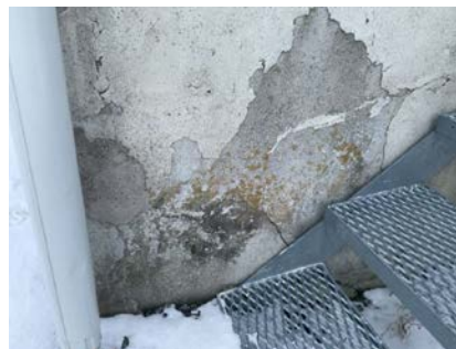
Sprekk i mur ved inngang i sør.
