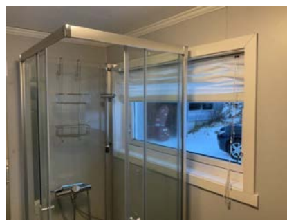
Kondensskader innvendig på badevindu.
