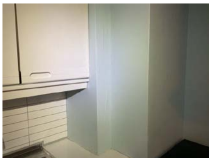
Skade på tapet i kjøkken.
