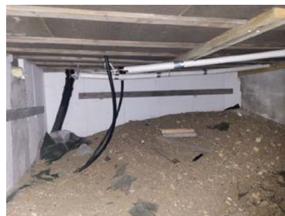
Kryp kjeller med avløp og vannledninger.
