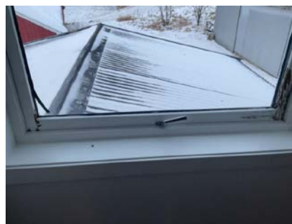
Kondensskader på ett vindu i loftetasjen.
