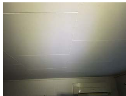
Synlige spiker i himlingsplater.
