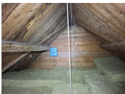
Ingen lufting i gavlvegg mot øst.
