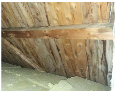
Fuktskjolder i undertak.
