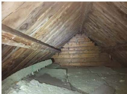
Ingen lufting i gavlvegg mot vest.
