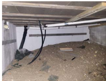
Avløpsrør av plast fra bad og toalett.
