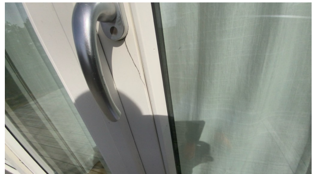
Skade på terrassedør.
