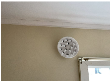
Veggventil i oppholdsrom for tilluft
