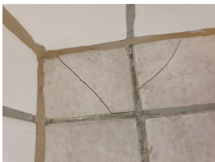
Sprukne gulvflis i dusjen.
