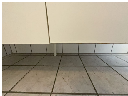
Svelling i nedre del av skap
