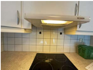
Kjøkkenventilator kan ikke slås av, og drar ut luft.
