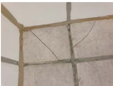
Sprukne gulvflis i dusjen.
