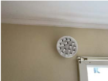
Veggventil i oppholdsrom for tilluft
