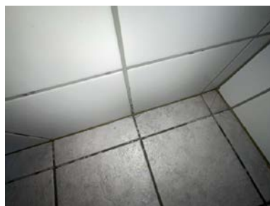
Sprukne gulvflis i dusjen.
