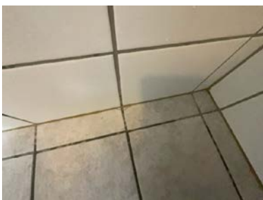
Sprukne gulvflis i dusjen.
