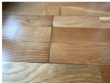
Idre fuktskade på parkett
