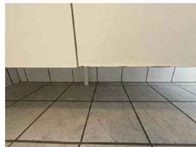
Svelling i nedre del av skap
