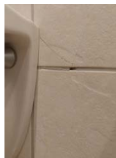
Påvist sprukne veggfliser, samt flisfuger med riss/sprekker.
