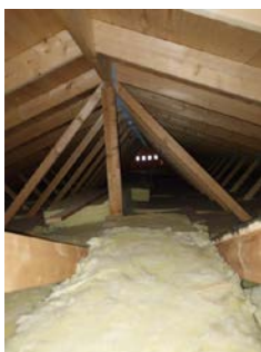
Begrenset besiktigelse av kaldloft ved tilbygg fra åpning i bordtak ved opprinnelige del.
