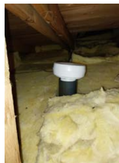
Durgo avløpsventil montert på kaldtloft. Ventil fremstår tilknyttet bad fra 2001.
