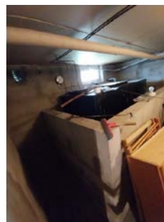
Oljetank plassert i kjeller, tank delvis innmurt i krybbe
