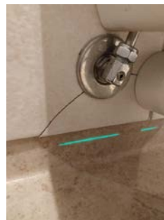
Påvist sprukne veggfliser, samt flisfuger med riss/sprekker.
