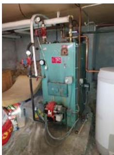
Fyrkjel/bereder med ekstern/tilleggsmontert ekspansjonstank og sirkulasjonspumpe.
