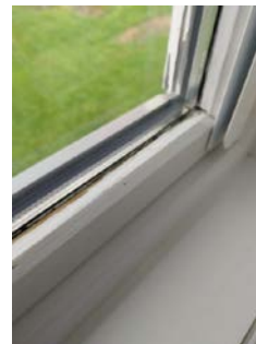
Enkelte vinduer med fuktmerker etter kondens.
