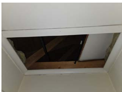
El-rør blokker delvis åpning til loft.
