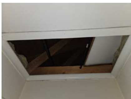
El-rør blokker delvis åpning til loft.
