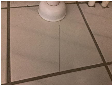
Eksempel på sprekk i flis.
