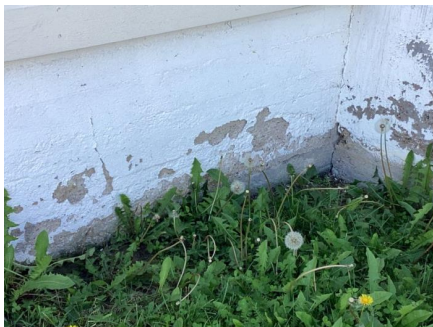
Eksempel på avskaling på grunnmur.
