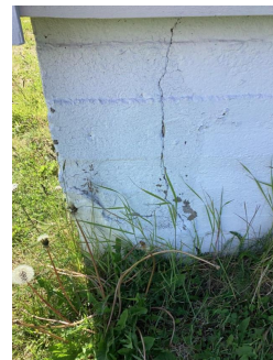
Eksempel på sprekk i grunnmur.
