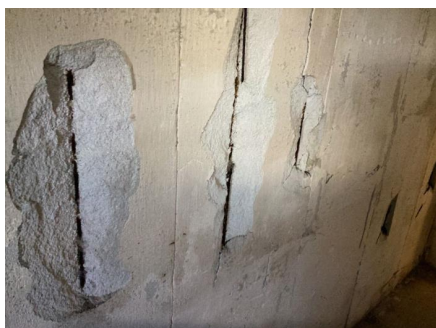
Eksempel på avskaling på elementer av lettbetong.
