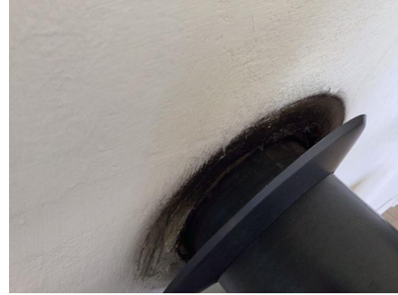
Misfarging rundt røykrør.
