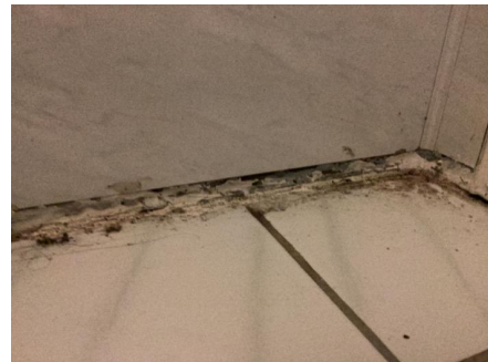
Misfarging og oppsprekking i fuger. Plater er ikke montert iht. anvisning.
