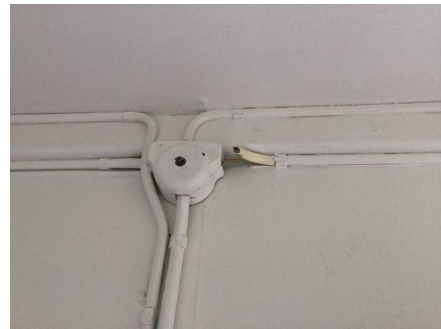
Avklippet kabel i entre.
