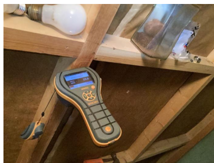
Fuktmåling viser høyt fuktinnhold i treverk høyt opp på vegg.
