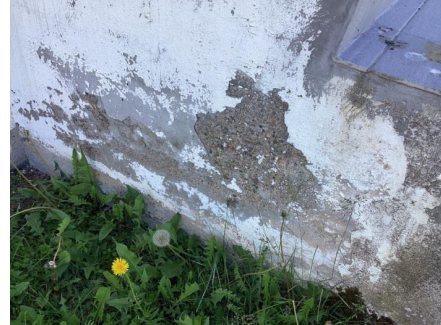
Avskaling på betongoverflate.
