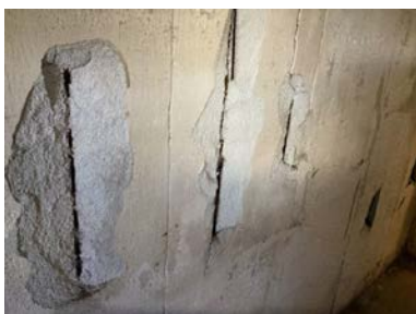
Eksempel på avskaling på elementer av lettbetong.
