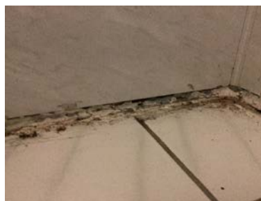
Misfarging og oppsprekking i fuger. Plater er ikke montert iht. anvisning.
