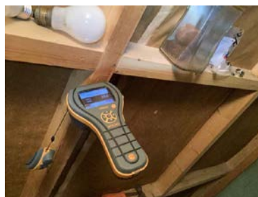
Fuktmåling viser høyt fuktinnhold i treverk høyt opp på vegg.
