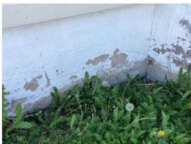
Eksempel på avskaling på grunnmur.
