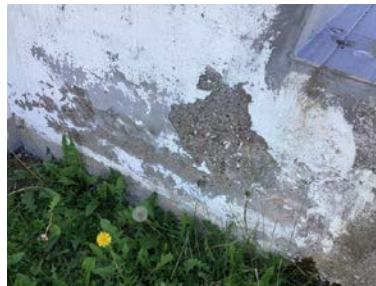
Avskaling på betongoverflate.
