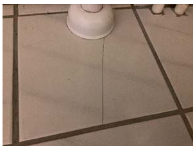
Eksempel på sprekk i flis.
