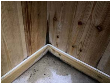
Synlig fuktpåkjønning på utforet kjellervegg.
