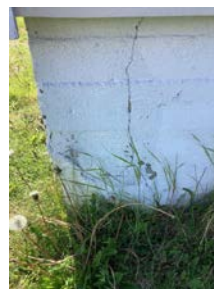
Eksempel på sprekk i grunnmur.
