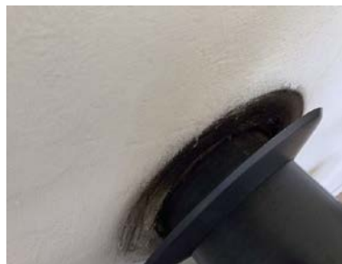
Misfarging rundt røykrør.
