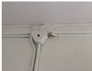
Avklippet kabel i entre.
