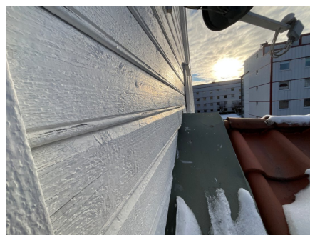
Stedvis noe dårlig kledning.
