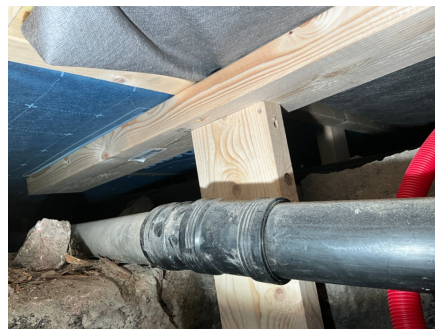
Eldre og nyere rør i kjelleren.
