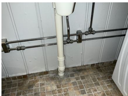
Fuktskader på overflatene.
