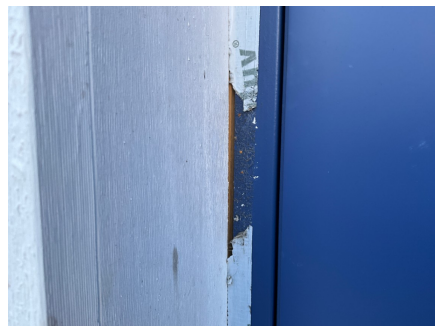
Utettheter rundt døren i front, vil bli utbedret av eier før salg.
