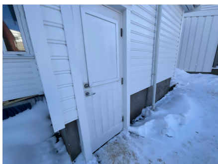
Fuktskader på døren.
