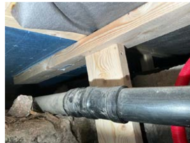
Eldre og nyere rør i kjelleren.
