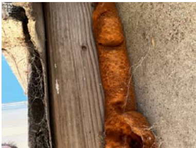
Skum som tetting, åpent for gnagere og ikke tilstrekkelig utlufting.
