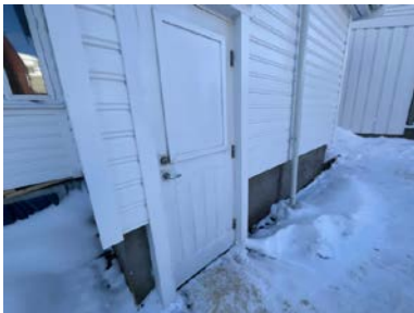
Fuktskader på døren.
