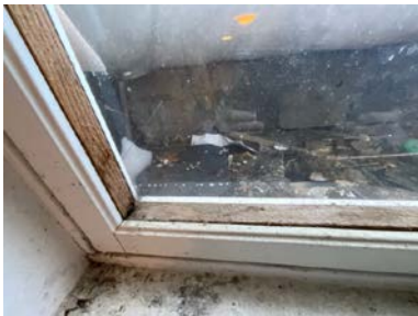
Mangler ett glass og kommer inn fukt i bunnen av vinduet.
