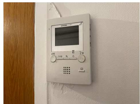
Dørtelefon i entre/gang.
