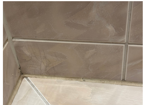
Riss/krakelering i veggflis i nedre del i dusjsone.
