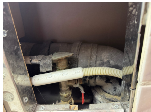
Stoppekran på bad.
