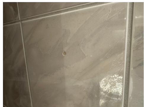
Sår i veggflis. Må anses å være normal slitasje.
