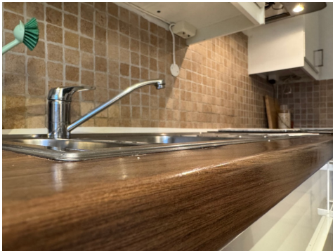
Fuktutsvelling i benkeplate v/ vask.
