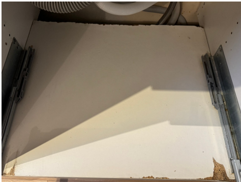
Slitasje/fuktutsvelling i skapbunn under vask.
