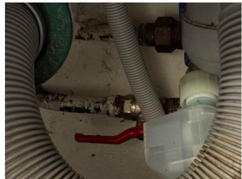
Stoppekran i kjøkkenskap.
