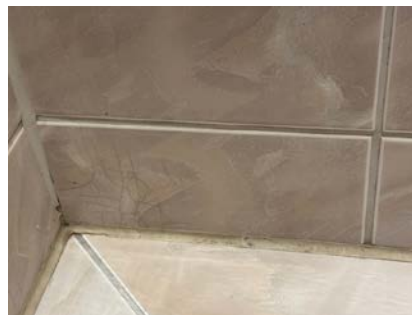
Riss/krakelering i veggflis i nedre del i dusjsone.
