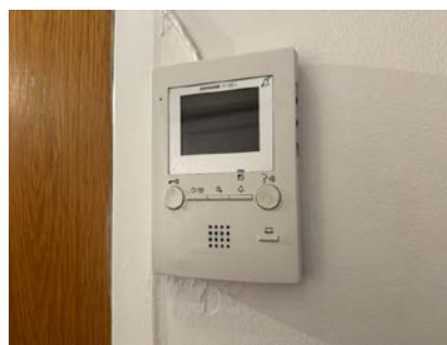
Dørtelefon i entre/gang.
