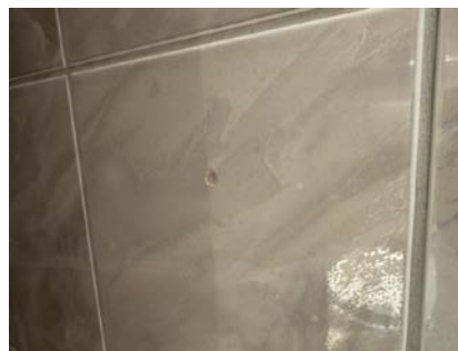
Sår i veggflis. Må anses å være normal slitasje.
