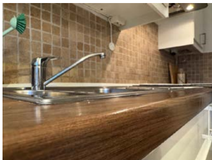
Fuktutsvelling i benkeplate v/ vask.
