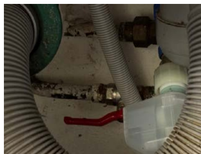
Stoppekran i kjøkkenskap.
