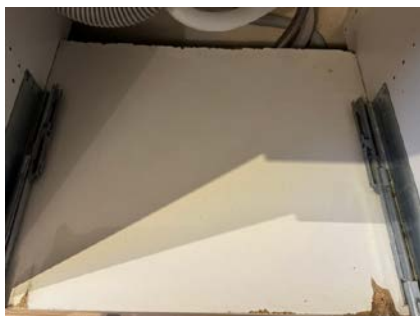
Slitasje/fuktutsvelling i skapbunn under vask.
