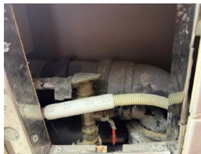
Stoppekran på bad.
