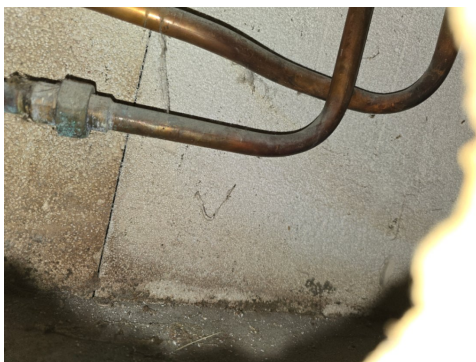
Vannrør i kobber.
