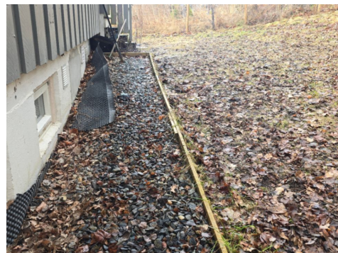
Fall mot grunnmur.
