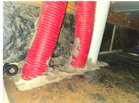
Utette rørgjennomføringer i gulv.
