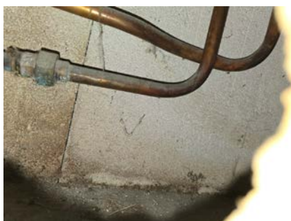
Vannrør i kobber.
