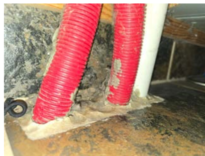
Utette rørgjennomføringer i gulv.
