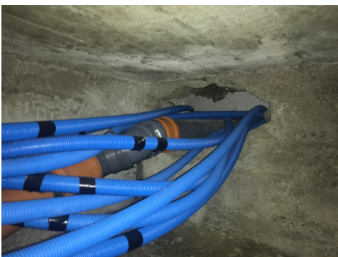
Rør fra bad og vaskerom i 1.etg samlet i kjeller.
