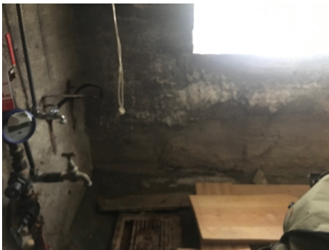
Saltutslag på vegger
