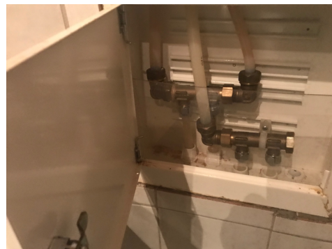
Rørskap plassert i bad i 2.etg.
