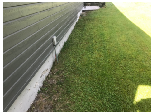
Terreng faller mot hus
