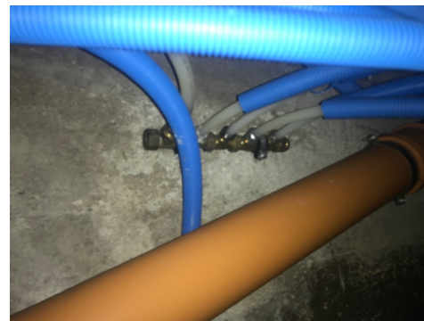
Koblinger i kjeller for bad, vaskerom i kjeller
