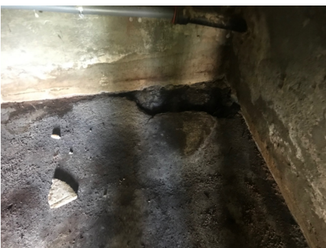
Generelt fukt i kjeller
