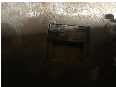
Saltutslag i vegge
