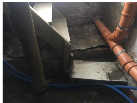
Trapp til kjeller uten rekkverk, trapp ikke i bruk.
