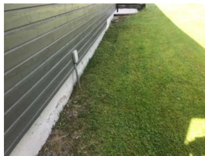
Terreng faller mot hus
