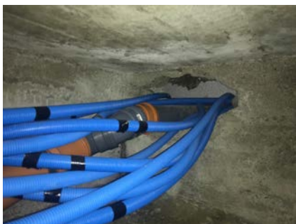
Rør fra bad og vaskerom i 1.etg samlet i kjeller.
