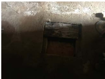
Saltutslag i vegge
