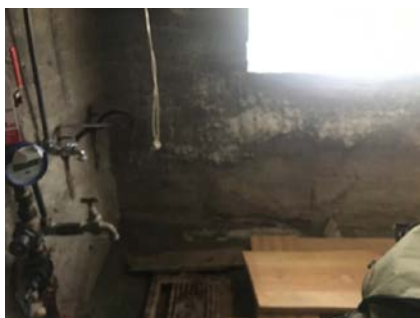
Saltutslag på vegger
