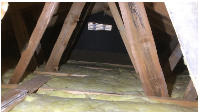
Ventiler i gavler
