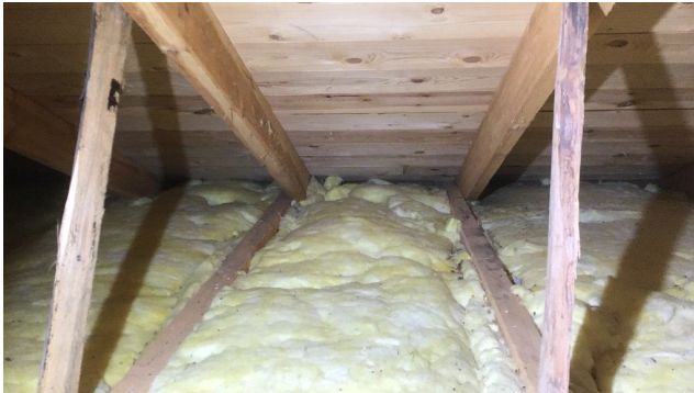
Tett i nedkant takutstikk
