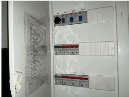
Automatsikringer i sikringsskap plassert i bod.
