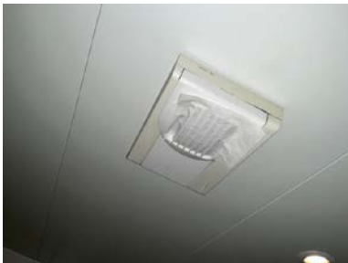
Kontroll av avtrekk.
