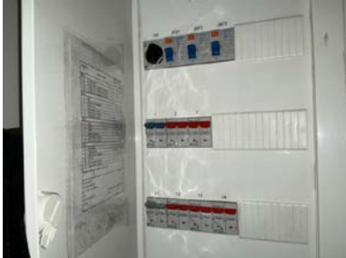
Automatsikringer i sikringsskap plassert i bod.
