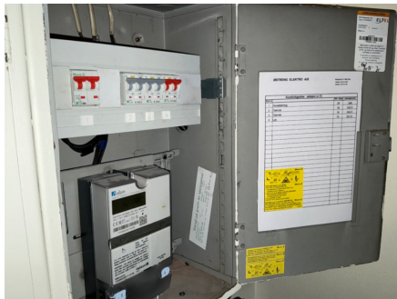
Automatsikringer i sikringskap plassert i gang/fellesareal.
